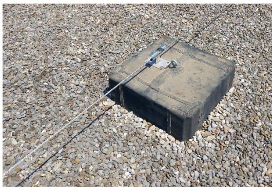
Foto 14: Detall del dau de formigó d'ancoratge de la línia de vida.
