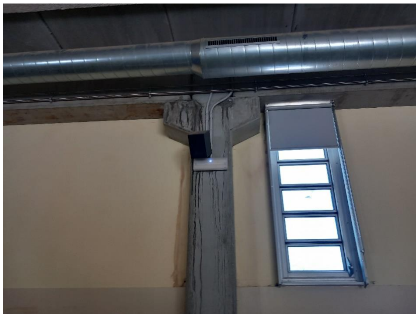
Foto 5: Filtracions de Coberta. Aigua a la columna
