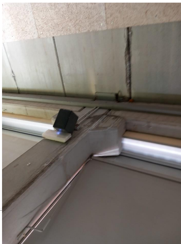
Foto 2: Filtracions de Coberta
