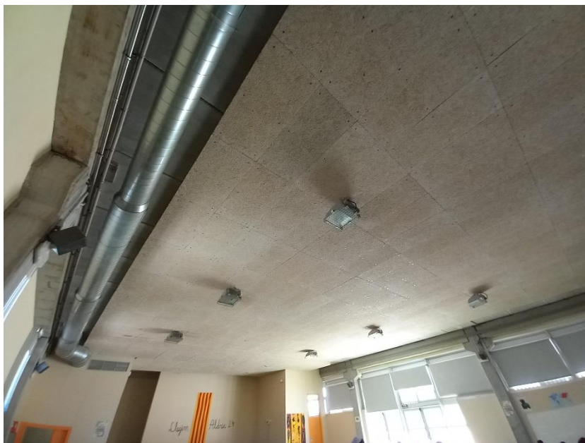
Foto 9: Imatge del conjunt del sostre
