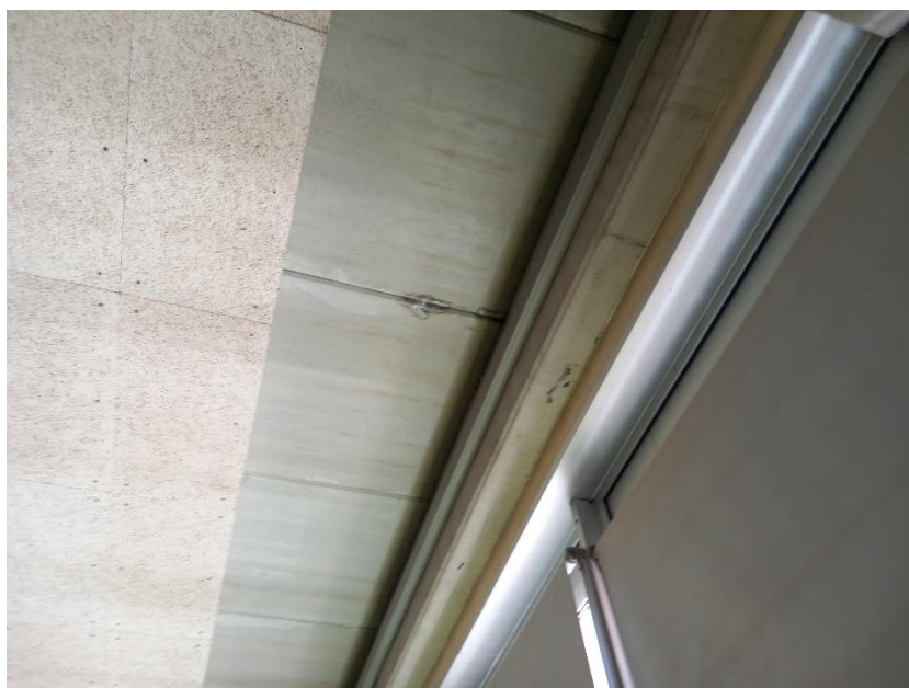
Foto 3: Filtracions de Coberta – Junta de prefabricat
