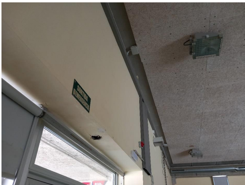
Foto 1: Deteriorament del pladur per Filtracions
