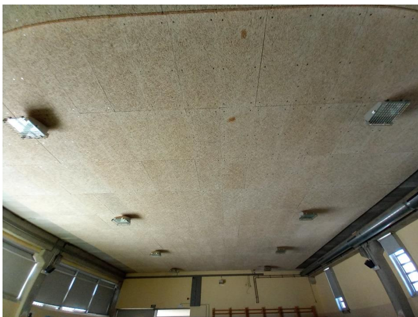
Foto 10: Imatge del conjunt del sostre
