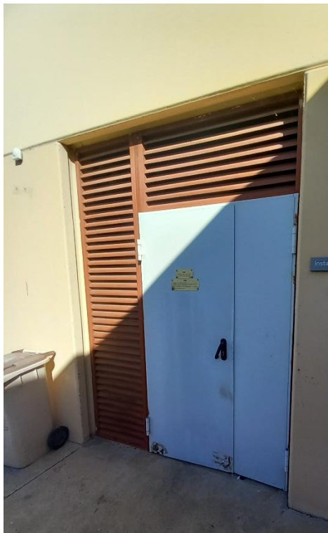
Fotografia 4: Porta actual de la sala de calderes
