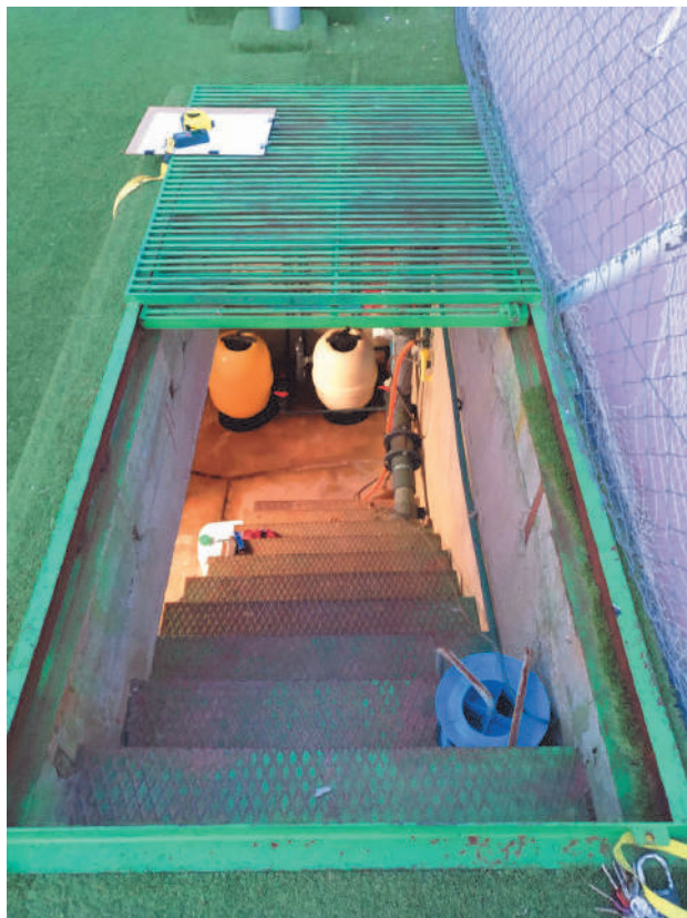
FOTO 12. Accés a filtres de piscines.
