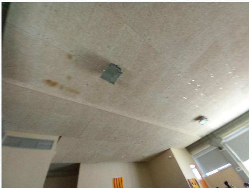
Foto 8: Taques humitat al revestiment del sostre
