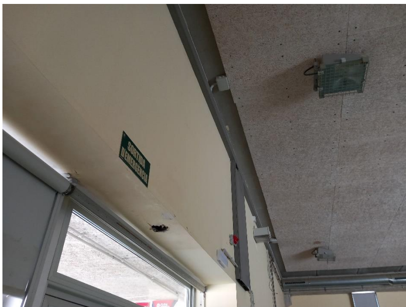
Foto 1: Deteriorament del pladur per Filtracions
