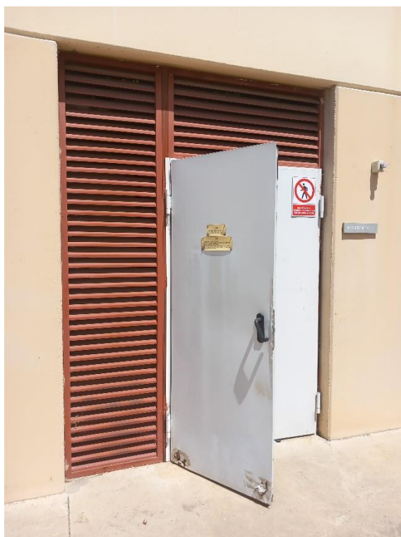
Foto 20: Vista de Conjunt de la Porta de la sala de calderes
