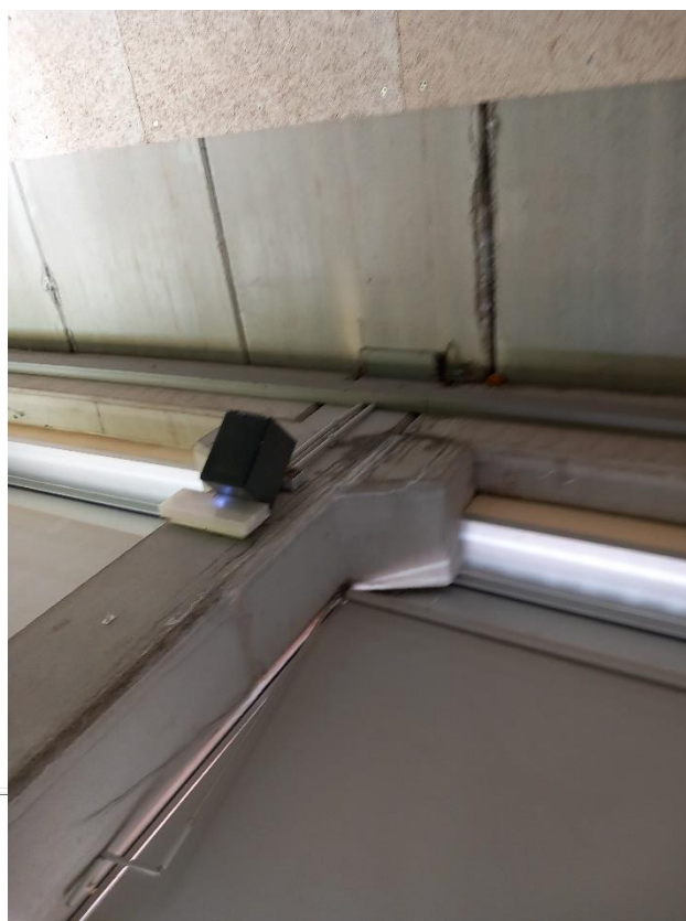
Foto 2: Filtracions de Coberta
