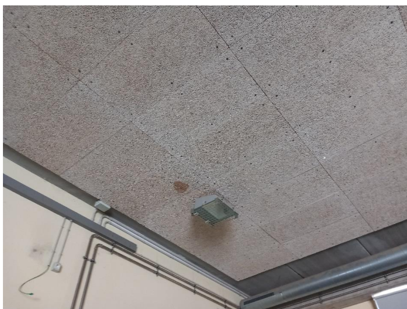
Foto 4: Filtracions de Coberta. Humitat a la placa
