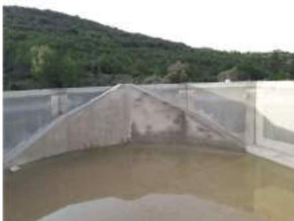
Exemple de doble rampa d'obra adossada a la paret del punt d'aigua.
