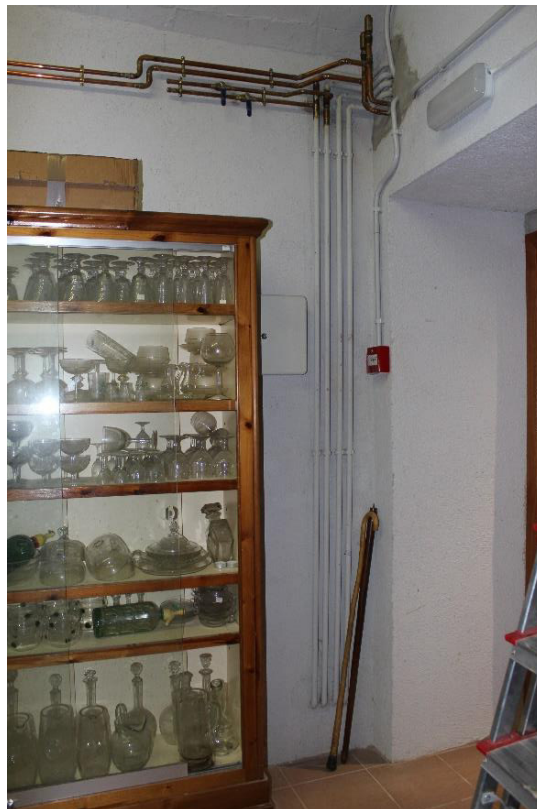
Detall de l'extrem dret (segons l'observador) del mur sud on s'observen els tubs per on circula l'aigua que alimenta els radiadors. També s'hi veu el pulsador d'alarma i la llum d'emergència.
