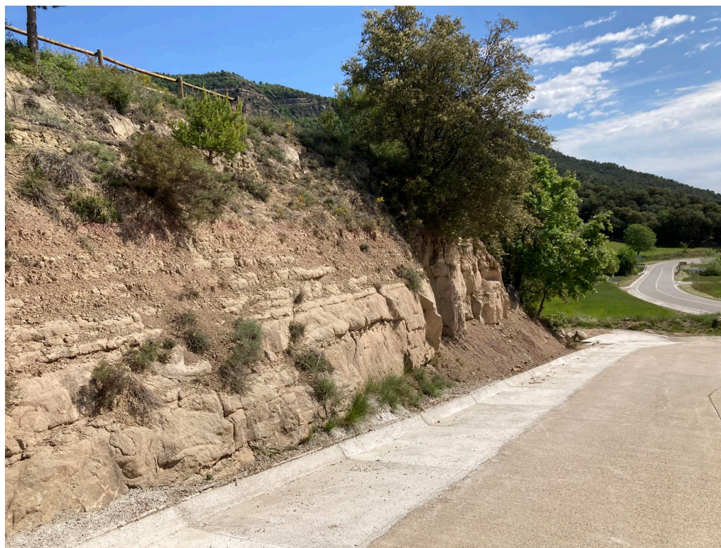
Vista general del punt d'arribada del tub de sortida del dipòsit
