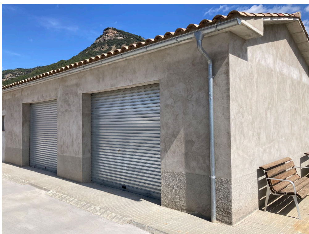
Caneló i baixant de la façana principal (costat sud). Interceptar a nivell del colze i portar a la façana posterior (costat sud)
