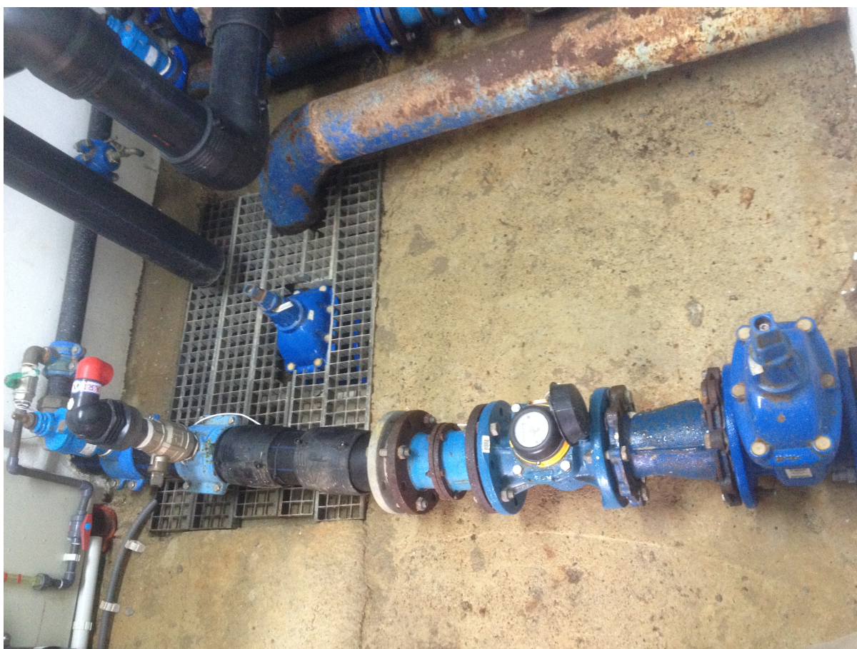
Conduccions i valvuleria d'entrada i sortides d'aigua del dipòsit
