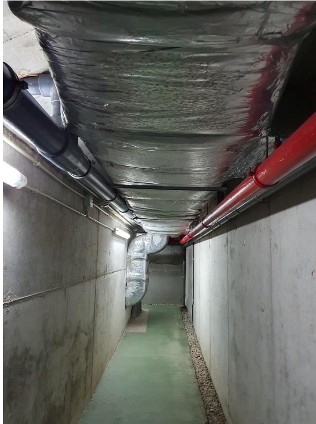
Galeria d'accés a sala tècnica deshumectadora.
