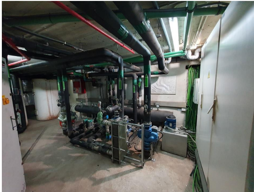
Vista general del col·lector de calor de distribució i quadre elèctric
