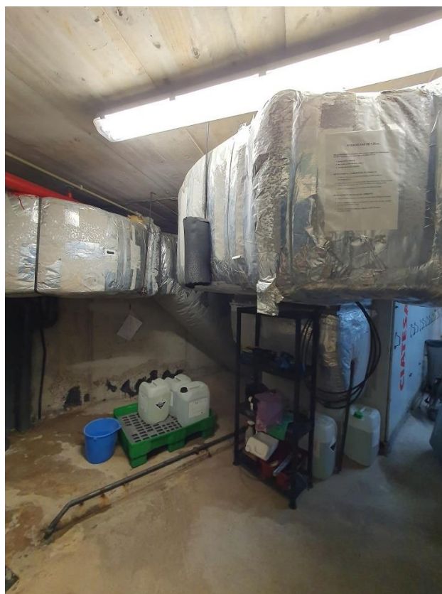
Conducte d'impulsió i retorn de deshumectadora.
