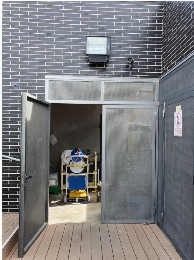
Accés a sala tècnica de planta coberta
