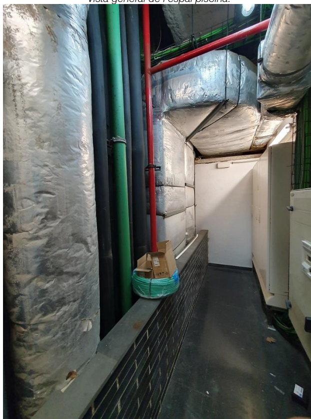
Pas muntants instal·lacions.
