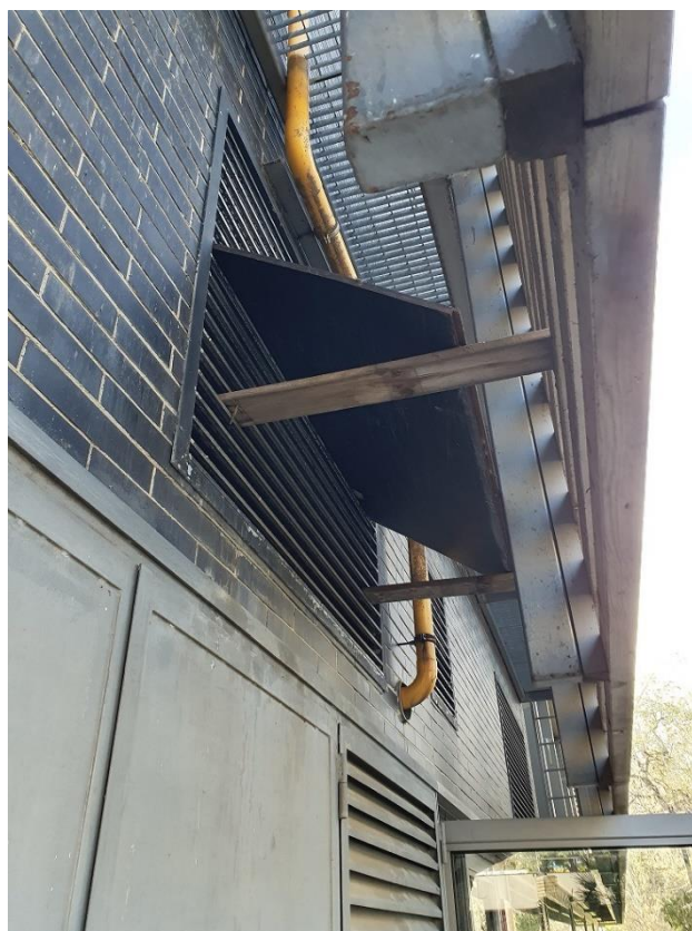
Presa i sortida d'aire primari de deshumectadora.
