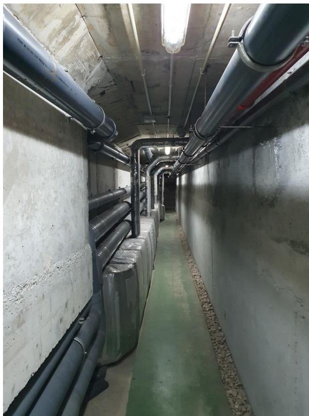
Galeria d'accés a sala tècnica deshumectadora.
