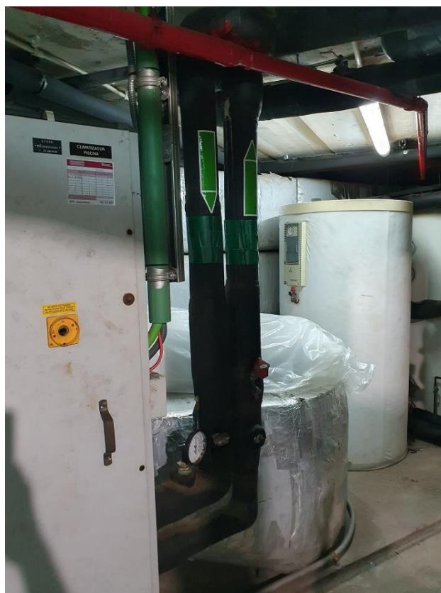
Connexions hidràuliques bateria de calor deshumectadora.
