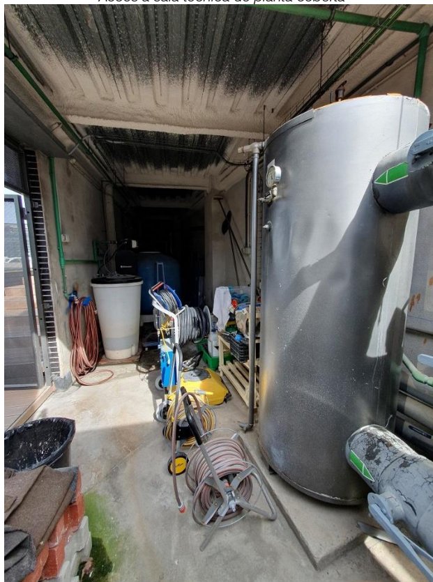
Vista general sala tècnica planta coberta
