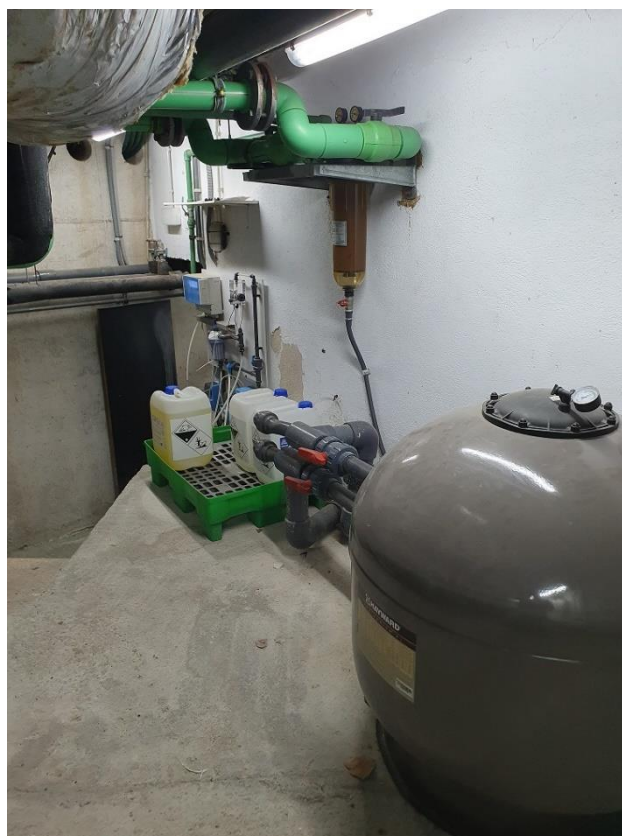
Equips de filtració de zona spa.
