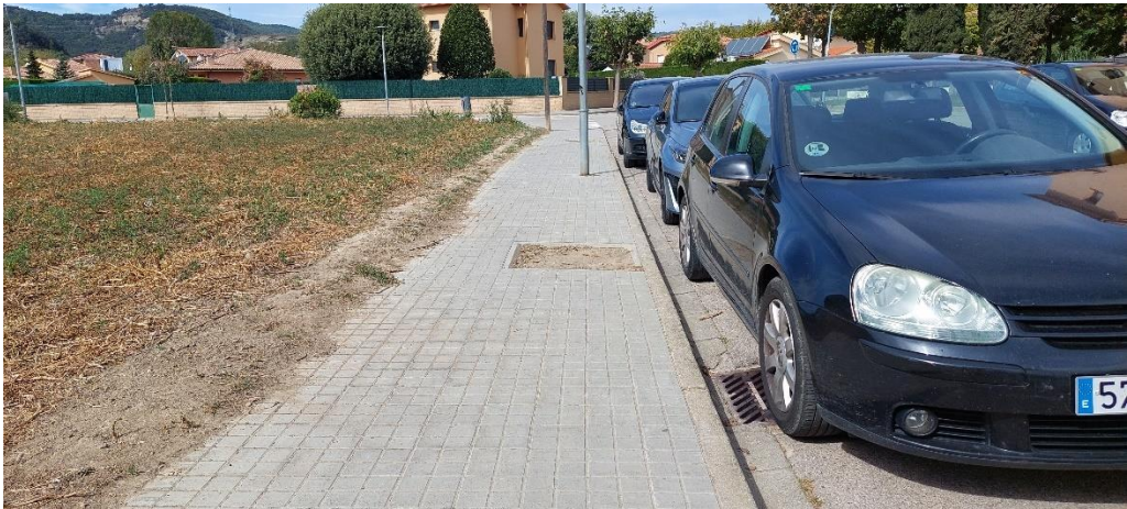
Figura 9. Carrer Pompeu Fabra amb vistes a Cantonada Carrer Torres i Bages. S' observa panot seguit de terreny natural.
