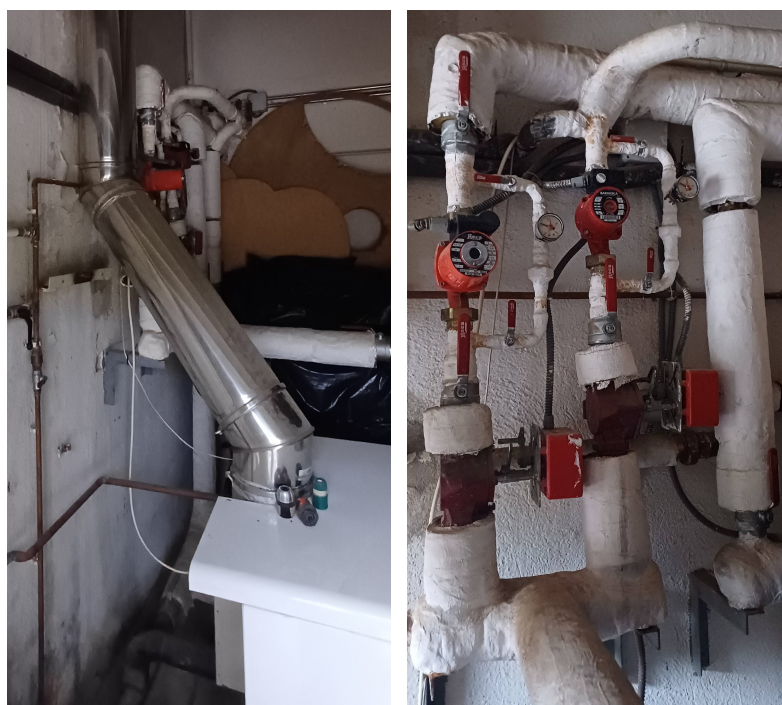
CALDERA A GAS EXISTENT
