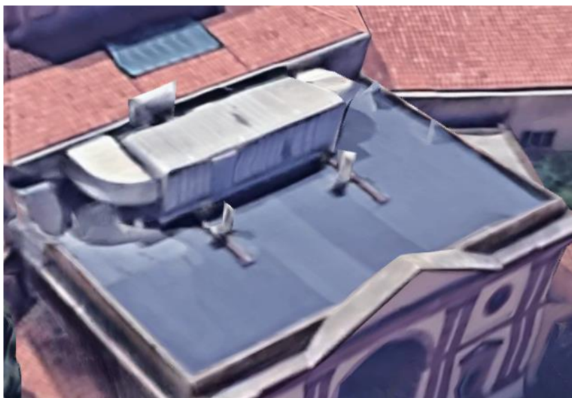
Climatitzador en Coberta Tècnica
