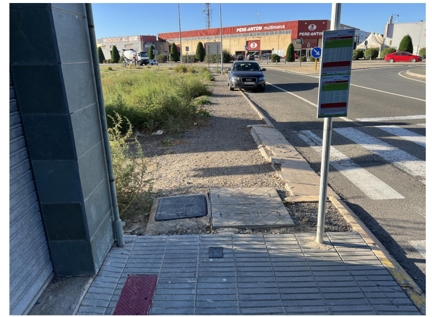
Foto: Final vorera 3 i gual a demolir i restituir
