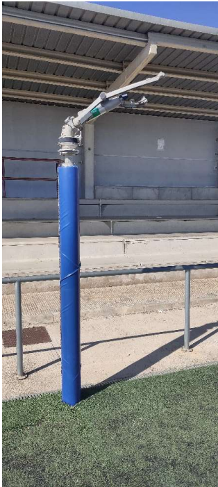
Detall d'un dels 6 canons elevats que formen el sistema de reg
