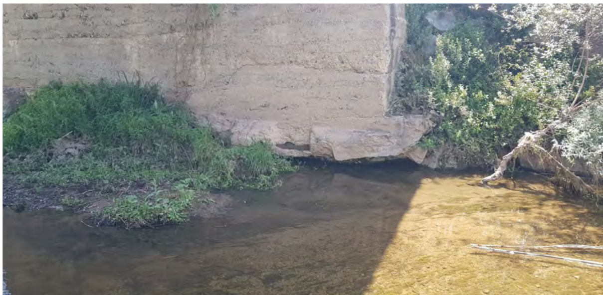
Imatge 19. Estrep esquerre del pont de Can Noguera que està soscavat
