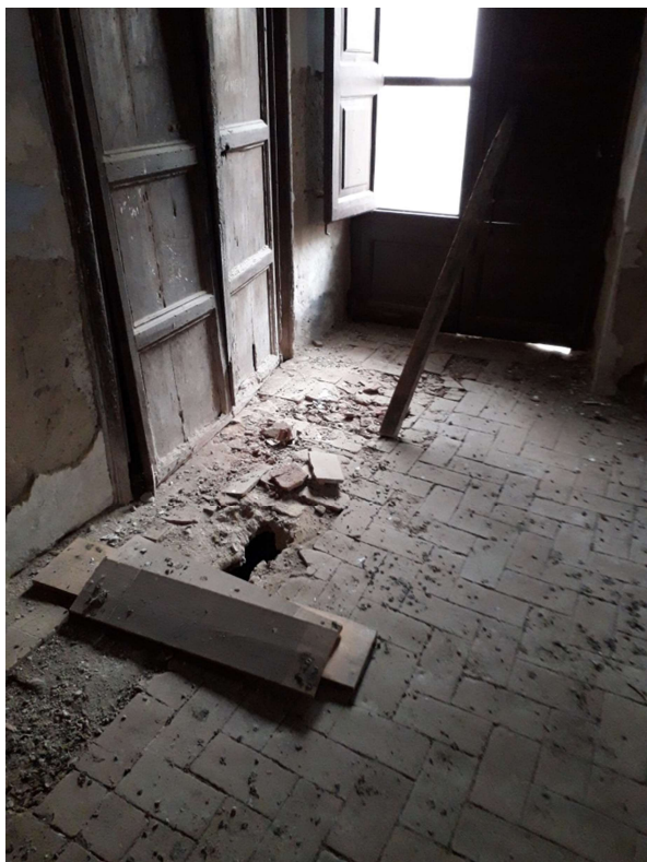
Paviment en mal estat
