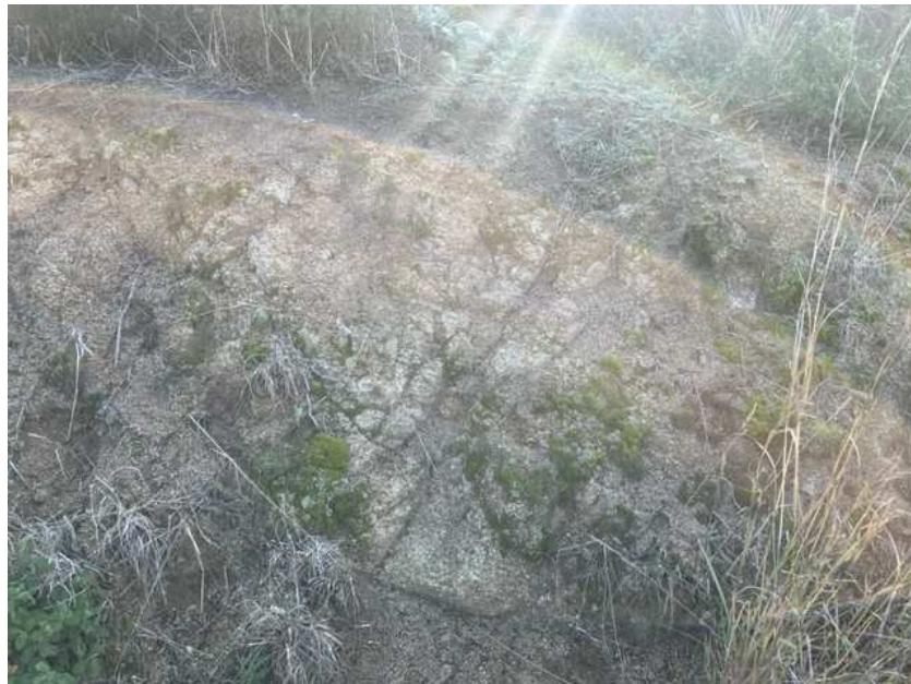
Foto 1. S'observa la alteració del substrat de la Estació geotècnica 1.
