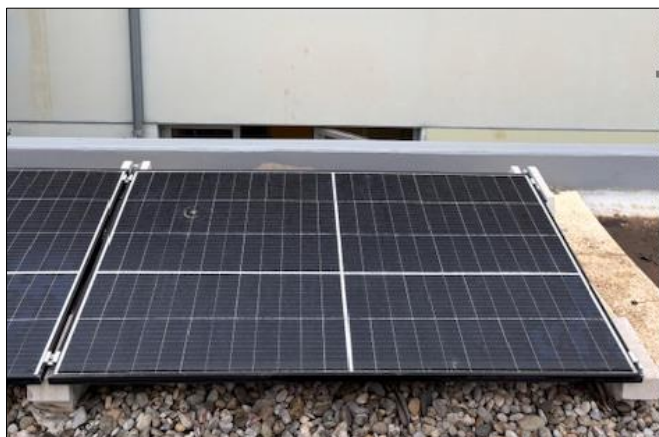
Detall mòduls danyats sobre coberta
