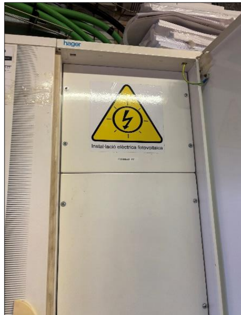
Connexió a l'embarrat del QGBT
