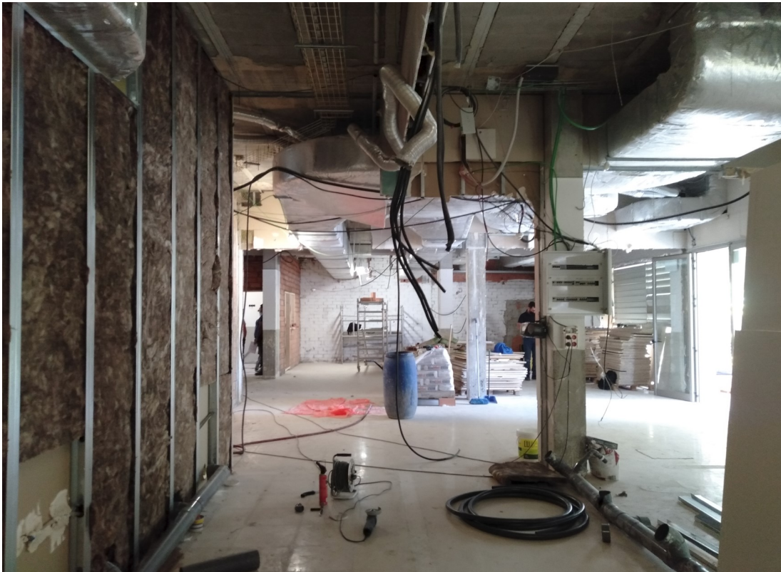
Fotografia 4 : Conduccions de la Climatització del CAP que passen pel cel ras del casal de Gent Gran.
