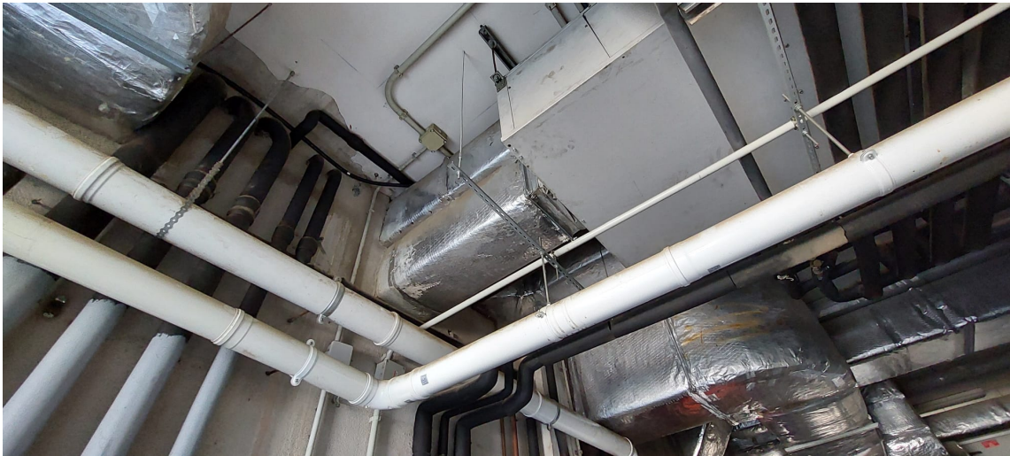
Fotografia 1 : Creuament de conduccions de la Sala d'Instal·lacions al casal de Gent Gran.
