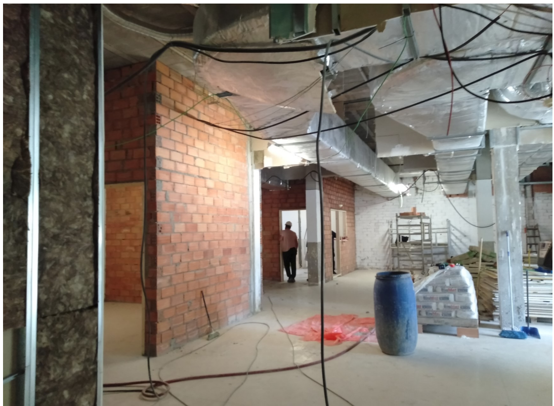
Fotografia 5 : Conduccions de la Climatització del CAP que passen pel cel ras del casal de Gent Gran.
