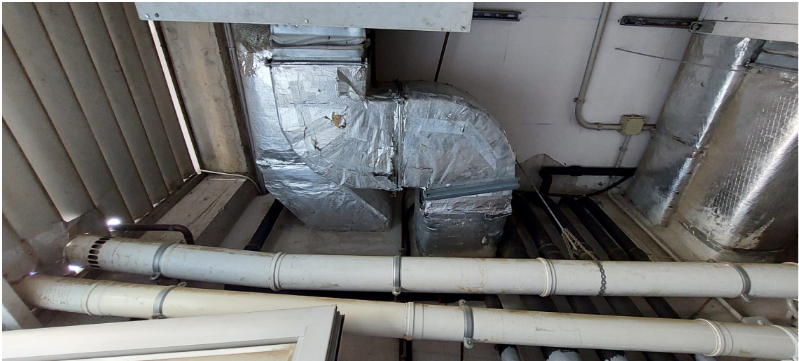
Fotografia 2 : Creuament de conduccions de la Sala d'Instal·lacions al casal de Gent Gran.
