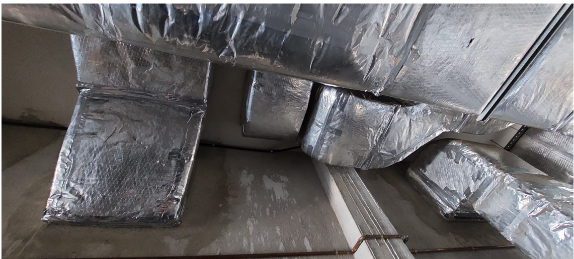
Fotografia 3 : Creuament de conduccions de la Sala d'Instal·lacions al casal de Gent Gran.
