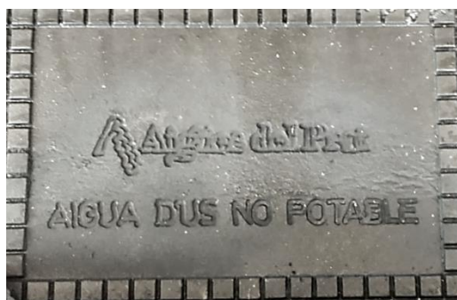
Marcat "Aigua d'ús no potable"
