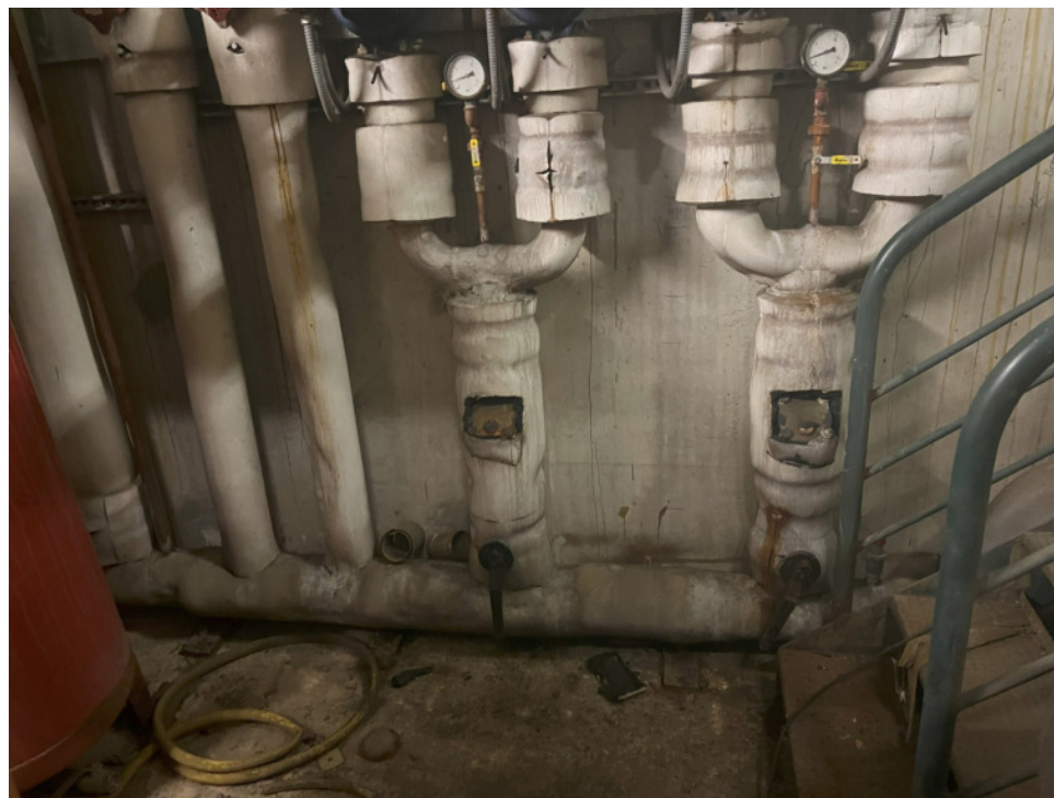
2.9.- Imatge 9. Sala de bombes
