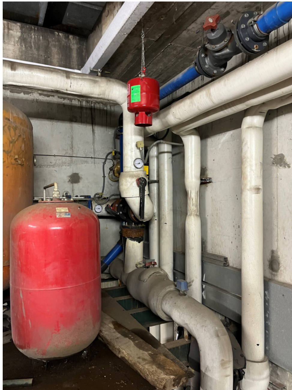
2.4.- Imatge 4. Sala de bombes
