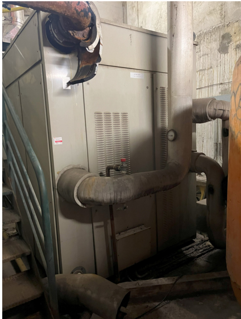
2.6.- Imatge 6. Sala de bombes
