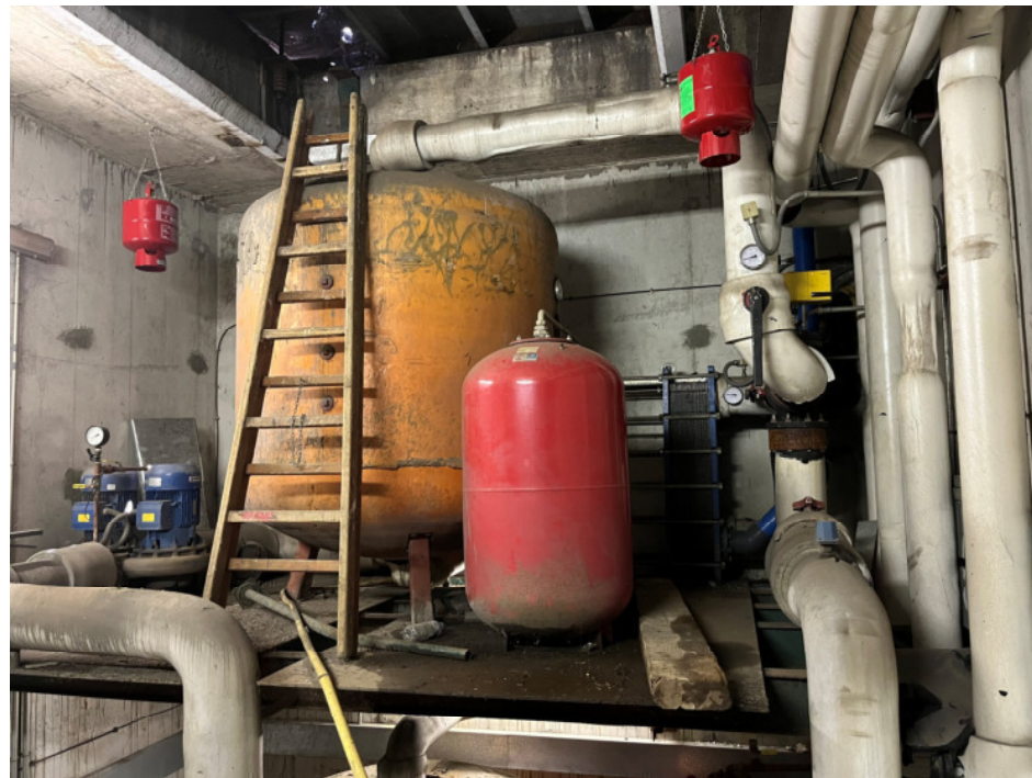
2.1.- Imatge 1. Sala de bombes
