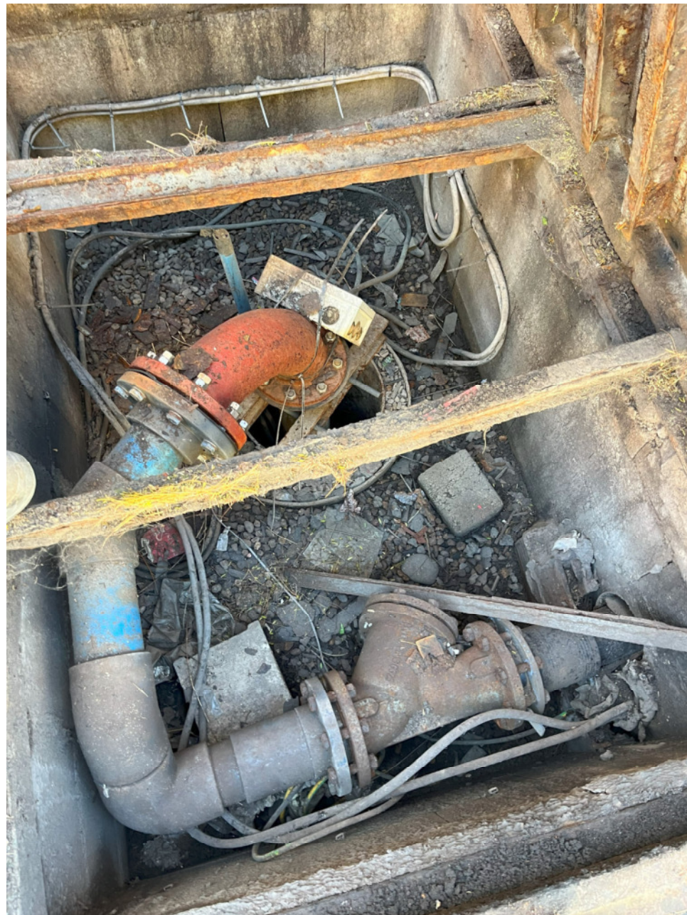
2.13.- Imatge 13. Filtre en arqueta exterior (Plaça de la pau)
