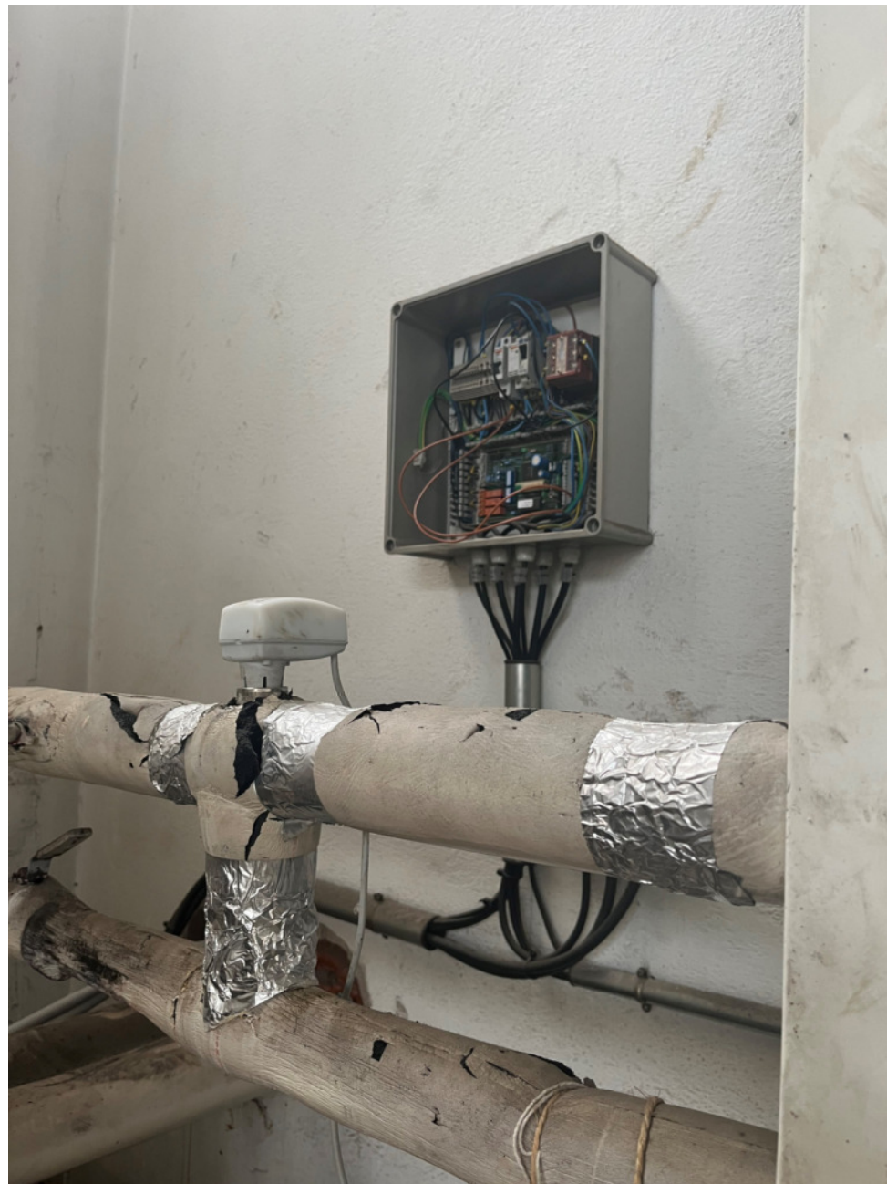
2.17.- Imatge 17. Quadre de control i vàlvules 3V fancoils
