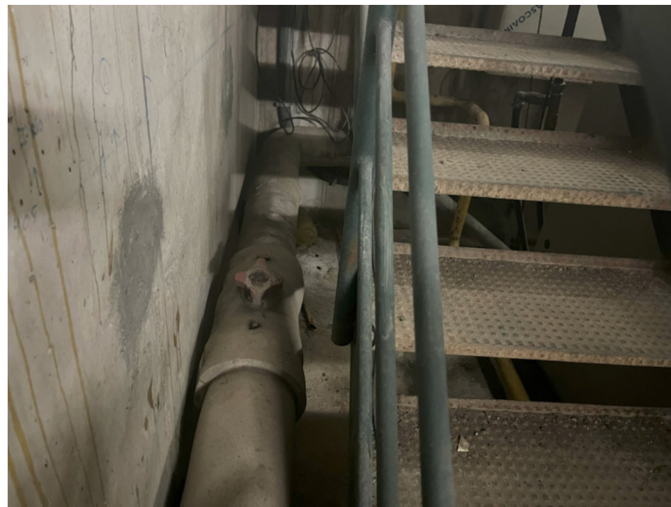
2.2.- Imatge 2. Sala de bombes
