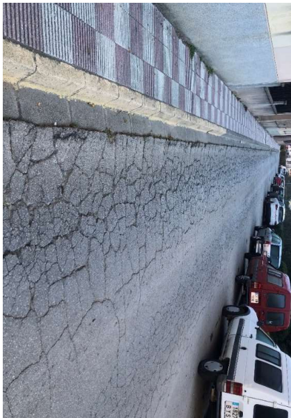
Fi una Deteriorament del pa inent al Carrer Ramon Fuster
