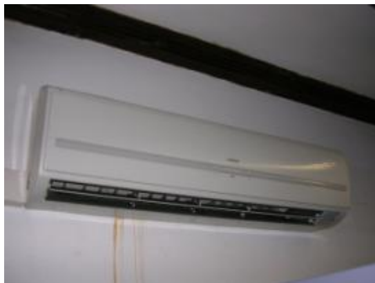
120 Sala Servidors ATI costat dret
