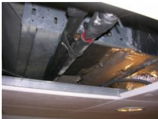
049 Fan-coil falç sostre zona treball Direcció
