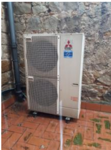
103 Condensadora sala Externs Digitalització
