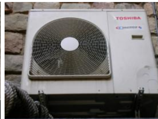
119 Condensadora Sala de La Caritat
