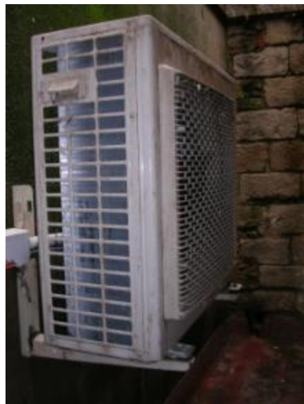
111 Condensadora Interior Sala Torres Amat
