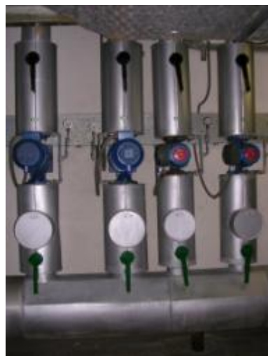
037 Bombes recirculació oficines i S. Lect.
