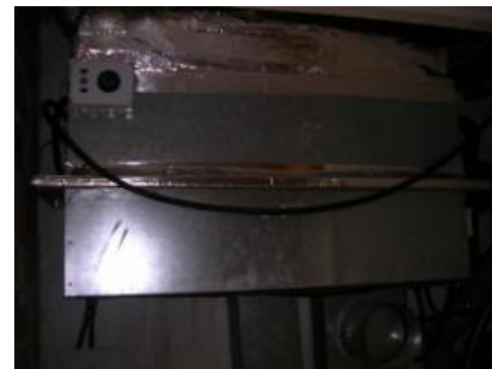
048 Fan-coils zones treball edifici oficines
