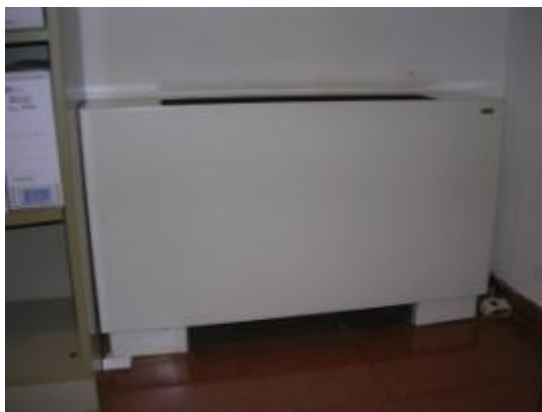
047 Fan-coils edifici oficines
