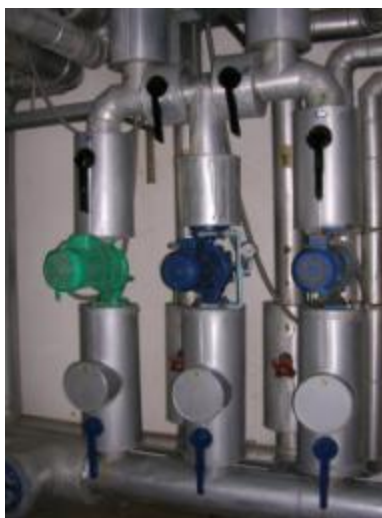
032 Bombes recirculació B1.1, B1.2 i B1.3
