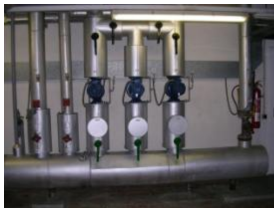
038 Bombes recirculació Bombes Calor n°1 i n°2
