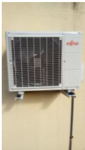
V034 P2 Condensadora Despatx Restauració
