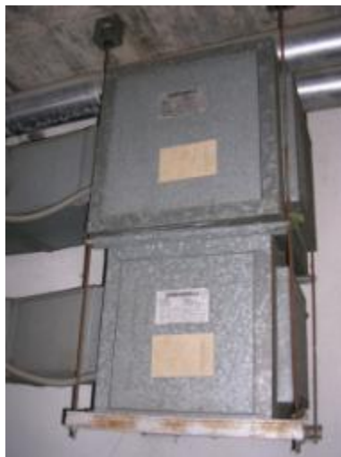
028 Ventilador sobrepressió escales
