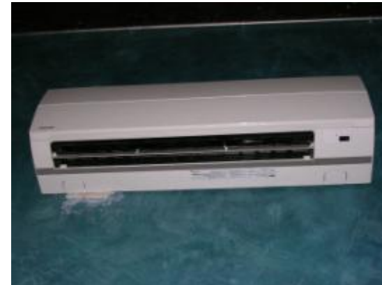
122 Sala Treball ATI al costat Sala de Servidors
