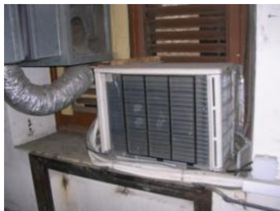
019 Condensadora fotos 017 i 018
