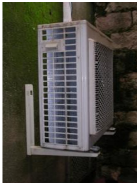
112 Condensadora Accés Sala Torres Amat
