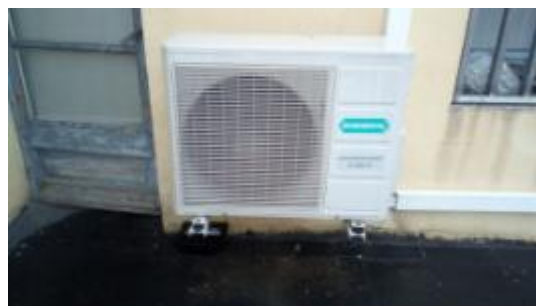
V020 Condensadora P2 Sala Gran Restauració
