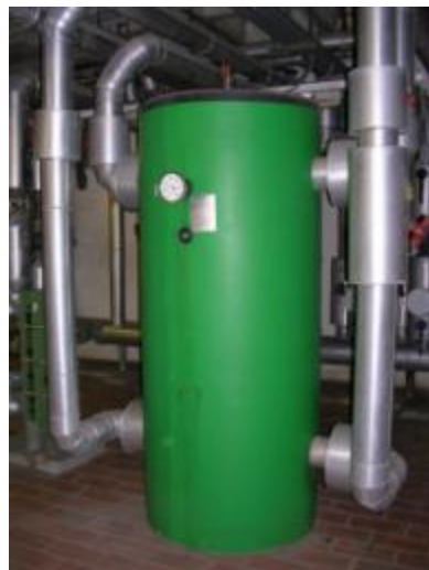
034 Dipòsit mescla aigua freda dipòsits
