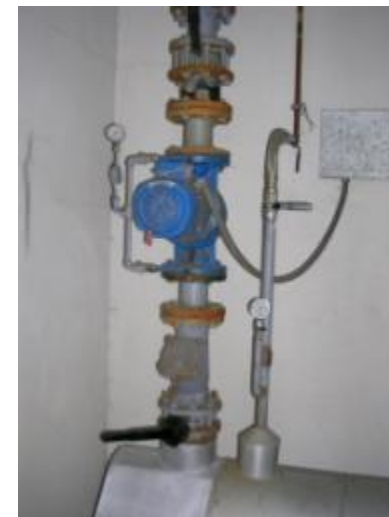
036 Bomba intercanviador i ompliment Bombes calor
