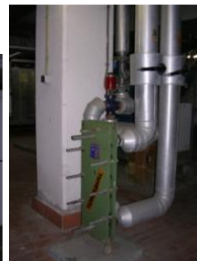
039 Bescanviador plaques Bombes Calor
