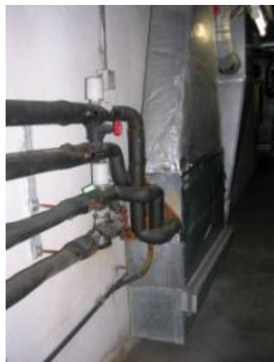
043 Fan-coils dipòsits llibres
