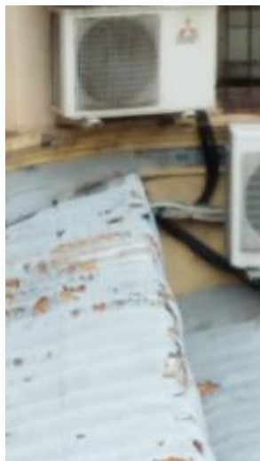
V007 Condensadora PB Material Menor
