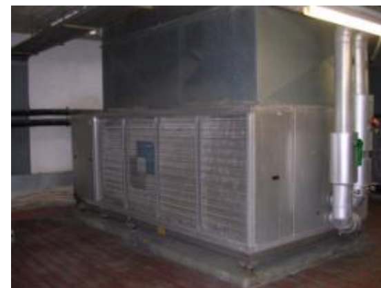
024 Bomba de Calor n° 1 Oficines i Sales Lectura
