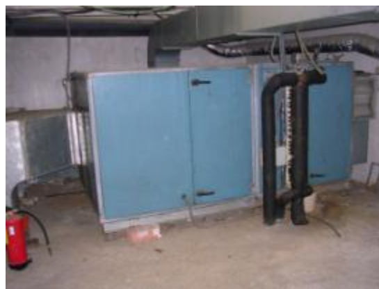
020 Evaporador amb bateria calor Magatzem Fonoteca
