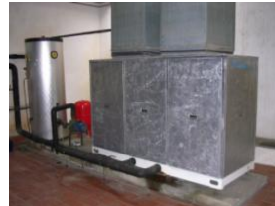
021 Bomba de calor magatzem fonoteca
