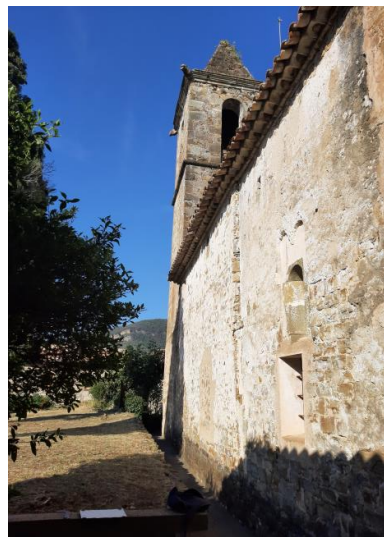
Il·lustració 5: Imatge de la façana de migdia. Hi podem observar com encara s'hi endevina la traça d'una finestra geminada romànica.
