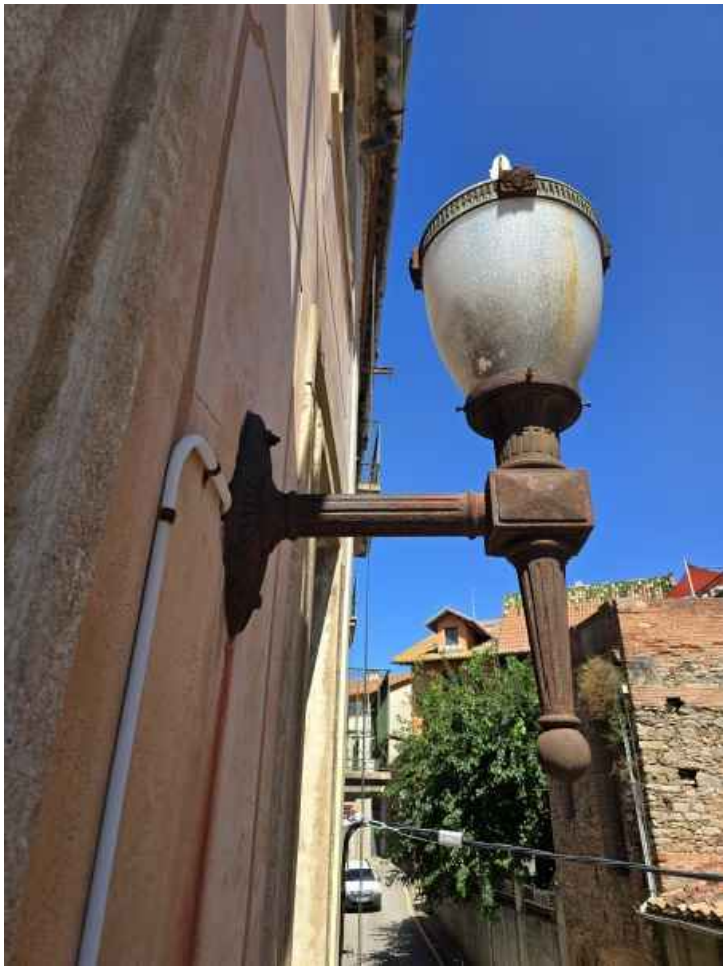
6. FANAL ADOSAT A LA PARET. INSTAL·LACIÓ VISTA. CAL OCULTAR EL CABLEJAT EN LA REHABILITACIÓ
