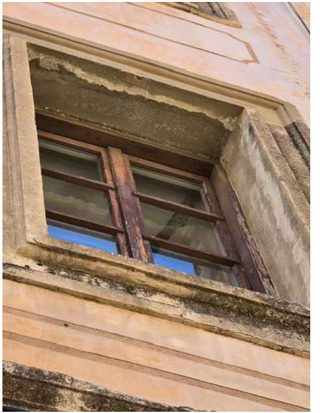
2. LLINDES, AMPITS I DINTELLS DE PEDRA, DETERIORATS.
