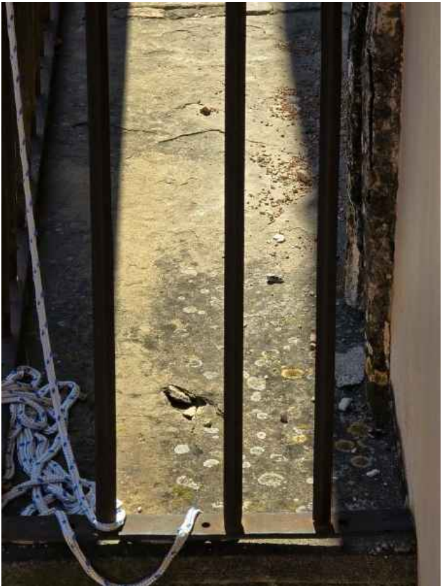
5. DETALL BARANA BALCÓ CARRER VIC, CALDRÀ REVISAR I SOLDAR BARROTS. REVISIÓ DE TROBADA AMB FAÇANA INCLOSA.
