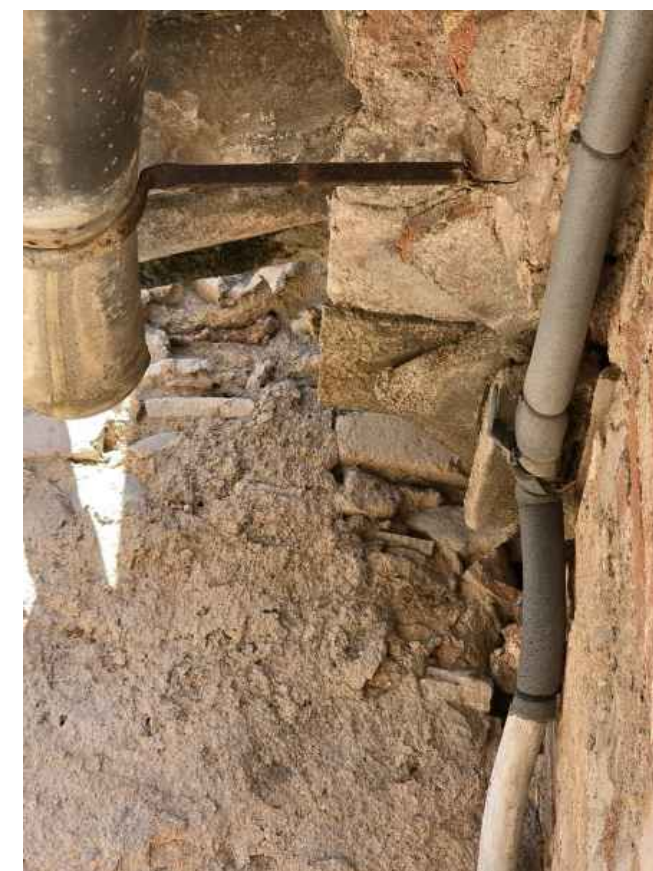
3. DETALL TROBADA FAÇANA I COBERTA. VISTA DEL CANALÓ EXISTENT A RETIRAR
