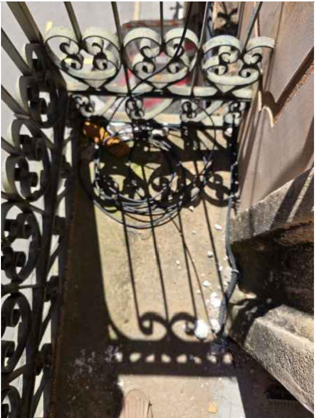
4. CABLEJAT PENJANT A FAÇANA I BALCÓ. CALDRÀ ORGANITZAR I PROTEGIR ADECUADAMENT.
