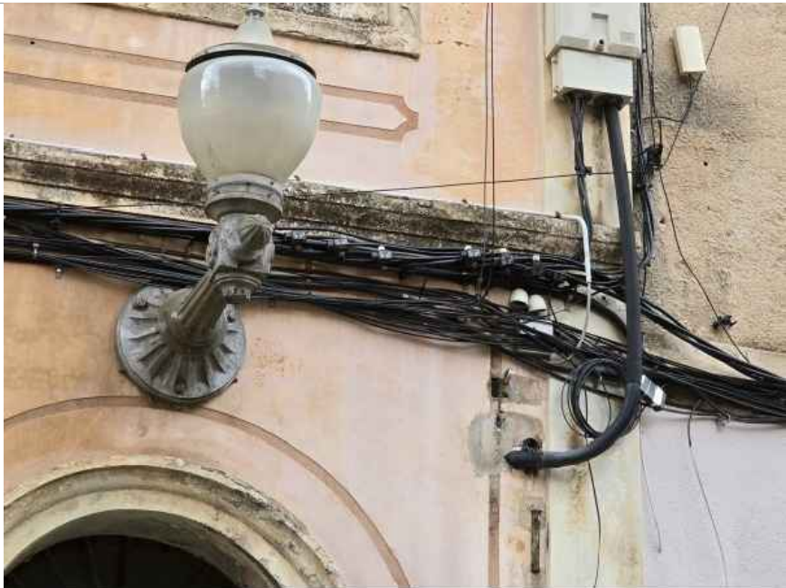
2. CABLEJAT ADOSAT A FAÇANA. CALDRÀ ORGANITZAR I PROTEGIR ADECUADAMENT.
