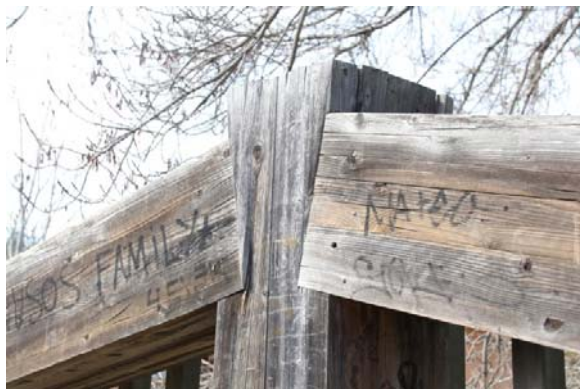
Imatge 4: Patologies observades
