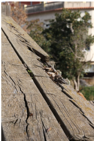
Imatge 6: Patologies observades
