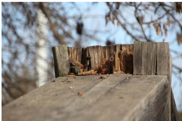
Imatge 3: Patologies observades
