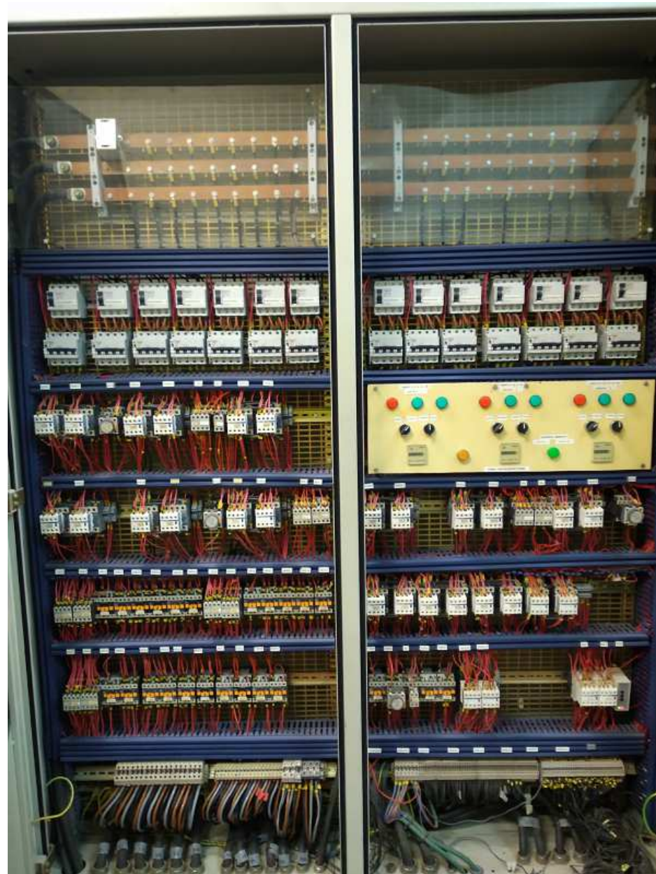
Armari de ventilació (No hi ha espai de reserva)
