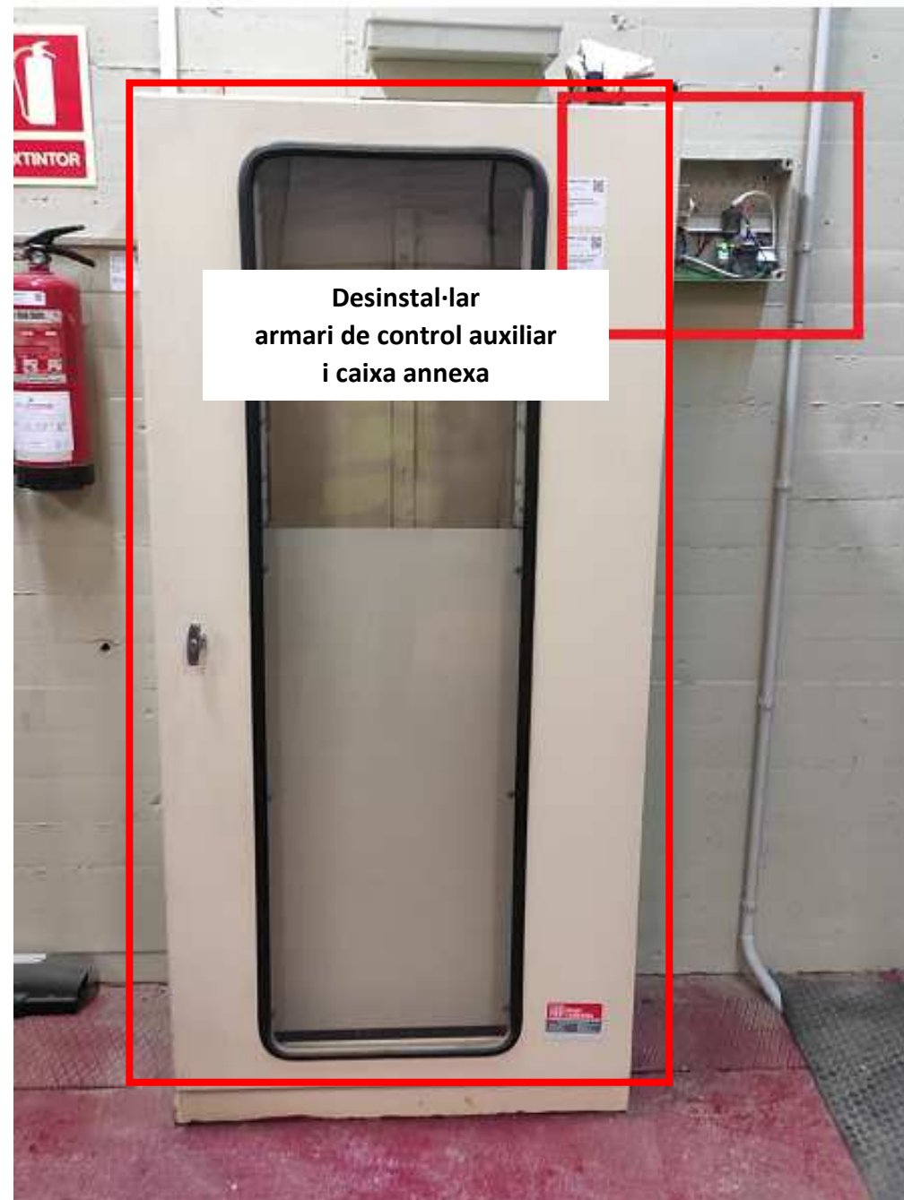
Ubicació de l'armari de control auxiliar i caixa annexa a desmuntar
