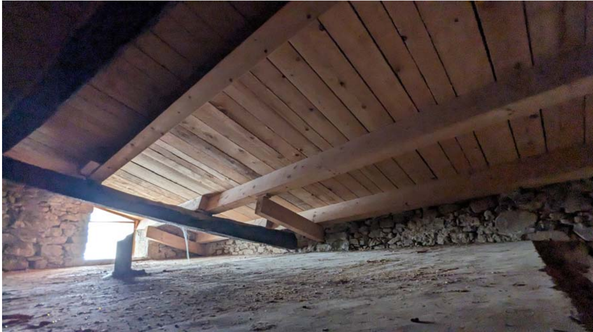
Foto 13: Vista actual coberta reformada i entresolat sotacoberta a enderrocar
