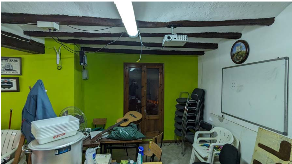
Foto 06: Vista interior obertura a façana lateral a Plaça Major de biguetes forjat sostre planta primera a reforçar
