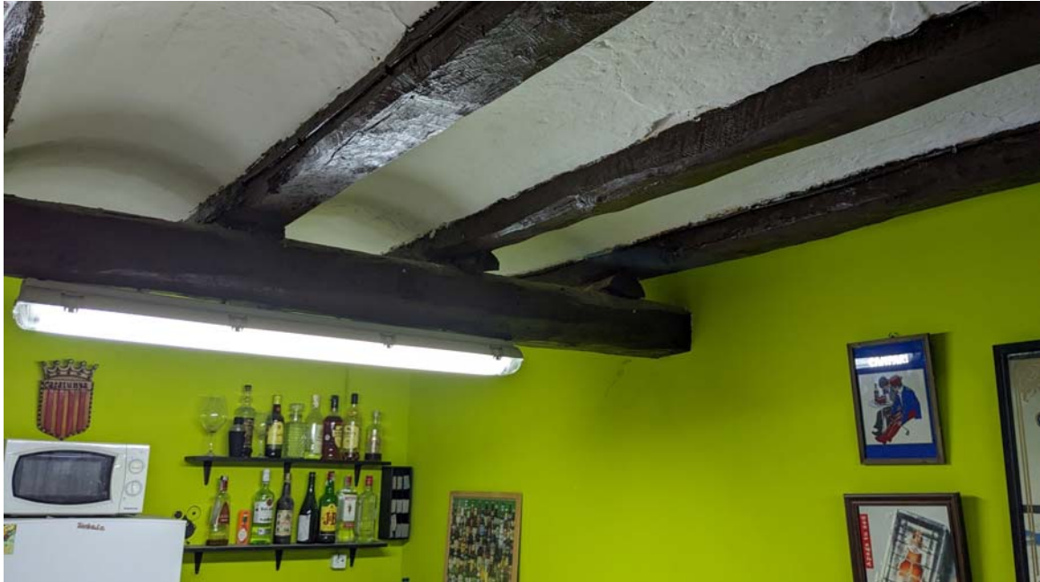
Foto 7: Detall biga principal i biguetes forjat sastre planta primera a reforçar
