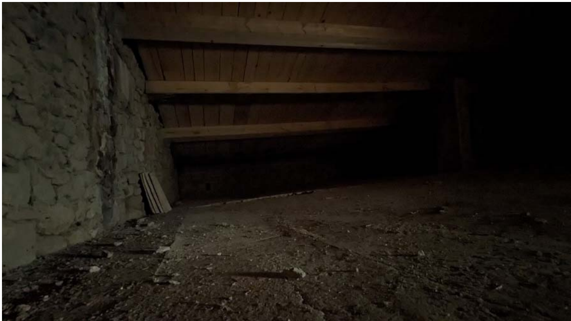
Foto 14: Vista actual coberta reformada i entresolat sotacoberta a enderrocar
