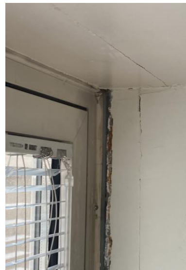
Fissures trobades entre diferents materials
