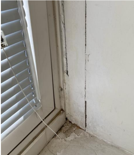
Fissures i esquerdes i despeniment del revestiment
