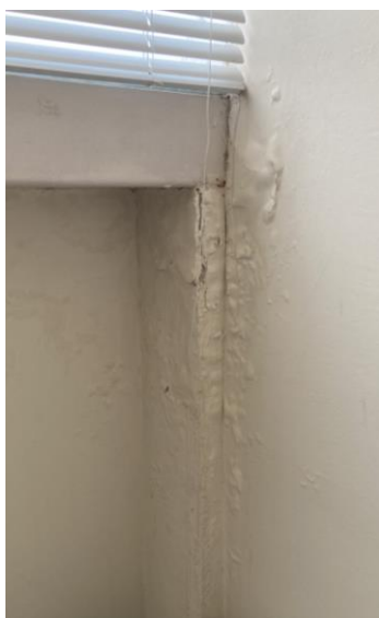
Entrada d'aigua i abombament del revestiment. Corrosió i òxid
