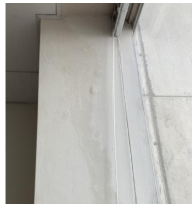
Presència d'humitats en revestiments
