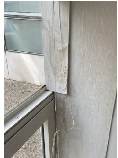
Compartimentació de cartró-guix en mal estat
