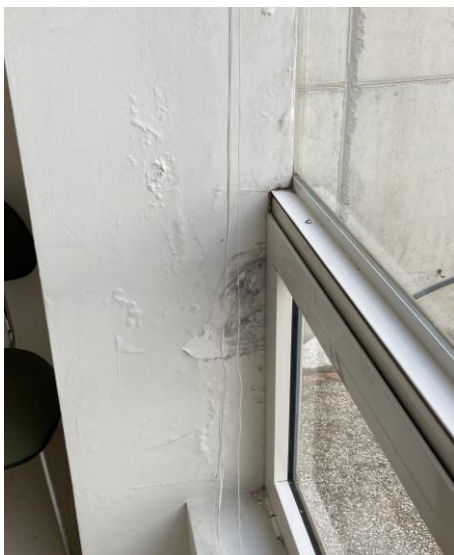
Presència d'humitats en revestiments
