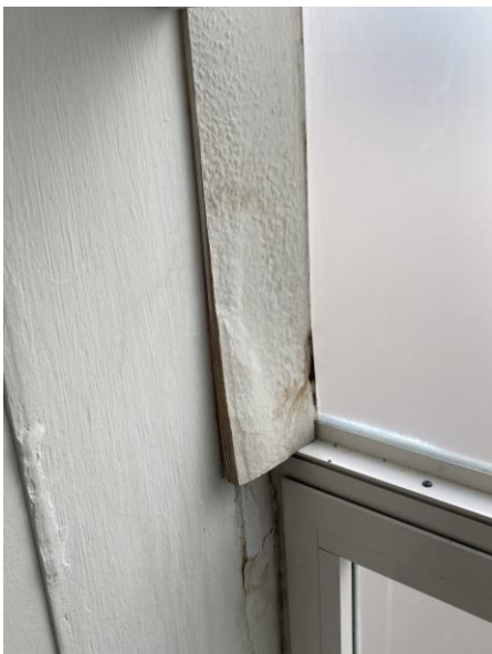
Compartimentació de cartró-guix en mal estat
