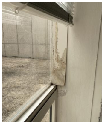
Compartimentació de cartró-guix en mal estat
