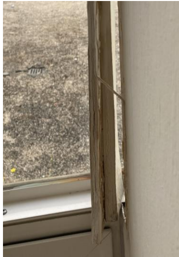
Elements en mal estat a causa de la presència d'aigua
