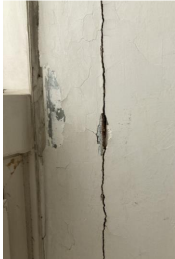
Fissures i esquerdes i despeniment del revestiment
