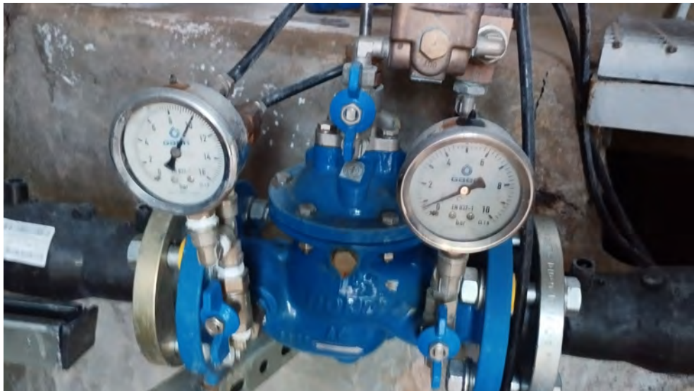
Interior de la caseta de vàlvules, vista de detall de la reductora de pressió
