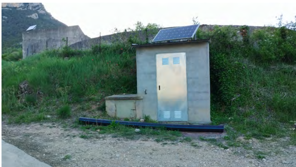
Caseta de cloració del dipòsit de 1.000 m 3
