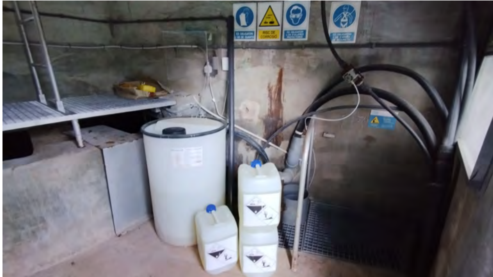
Interior de la caseta de vàlvules, vista lateral dreta
