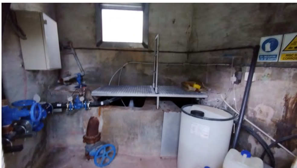
Interior de la caseta de vàlvules, vista frontal amb el dipòsit al fons
