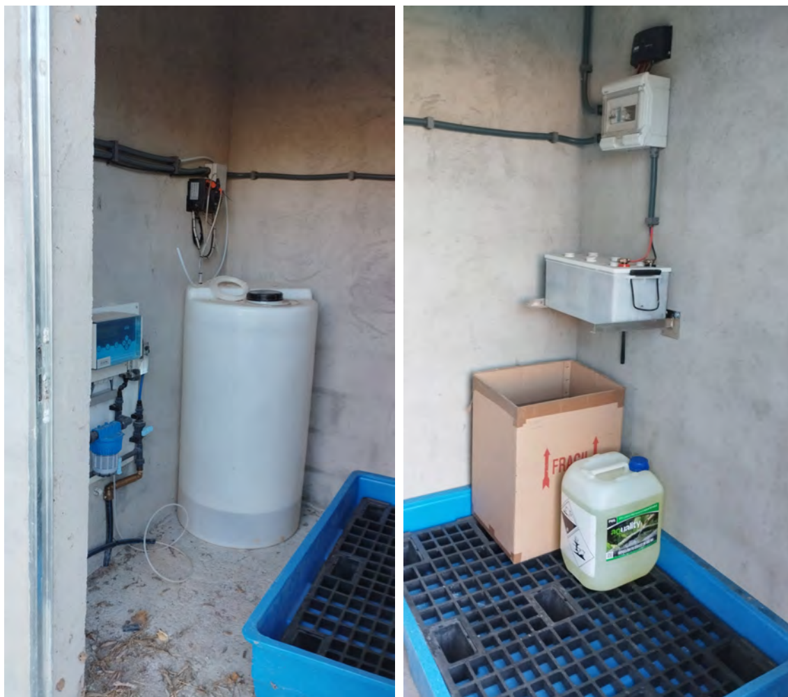
Interior de la caseta de cloració del dipòsit de 1.000 m 3
