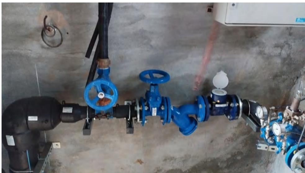
Interior de la caseta de vàlvules, costat entrada d'aigua
