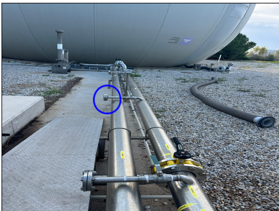
Fotografia núm.3: Canonades d'entrada i sortida del gasòmetre. La canonada de sortida del gasòmetre és la canonada d'entrada a la dessulfuració. Encerclat un altre punt disponible per mesurar el H_2S a l'entrada de la dessulfuració. El punt que es veu en primer pla de la imatge no seria adequat perquè si la dessulfuració està funcionant, la vàlvula grossa de papallona està tancada i no deixa passar biogàs.
