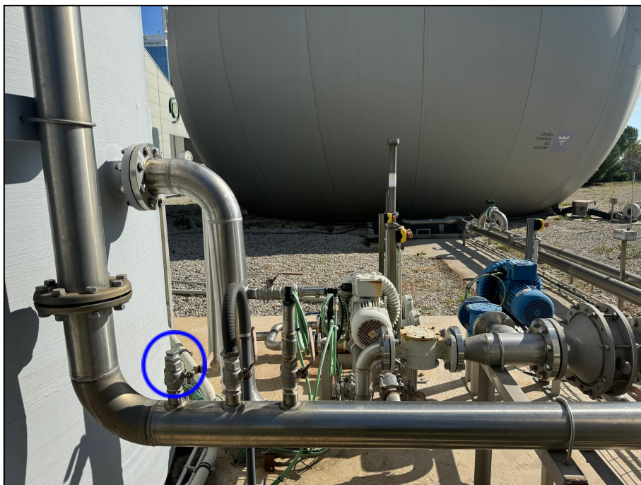
Fotografia núm.2: Canonades d'entrada i sortida de la dessulfuració, a la imatge un altre punt disponible per a la mesura de H_2S a la sortida dessulfuració encerclat.
