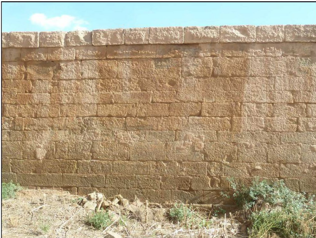
VISTA GENERAL- TRAM LLENÇ DE MUR INFERIOR BASSA A SANEJAR I RESTAURAR
