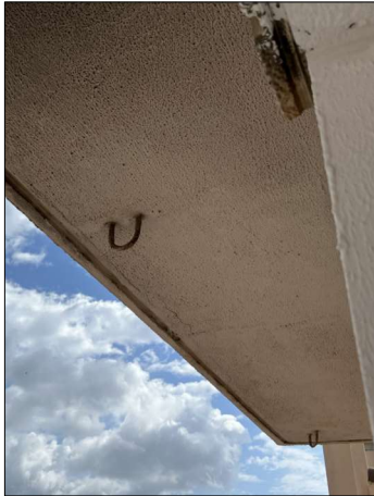
8A-2 Ràfec de façana nord
