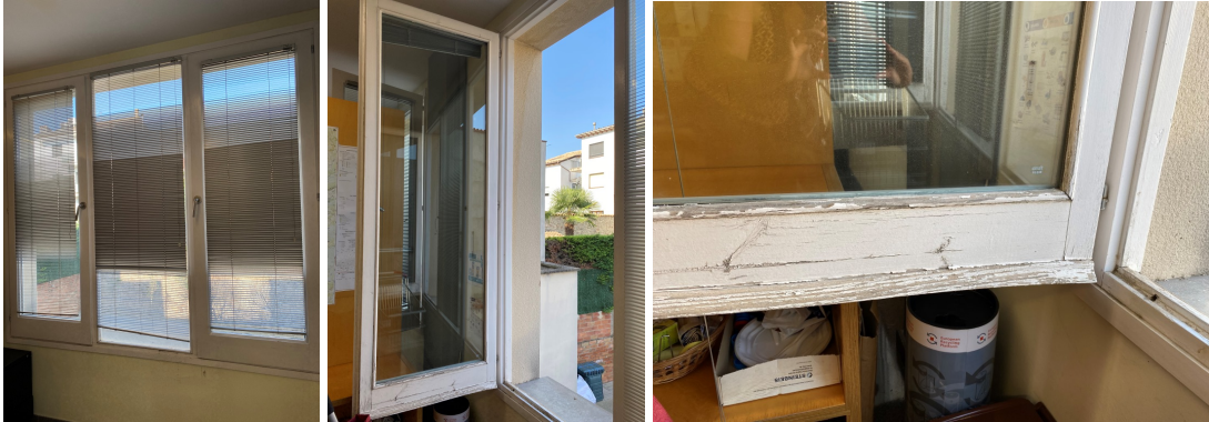
Fotografies estat actual fusteria façana oest
