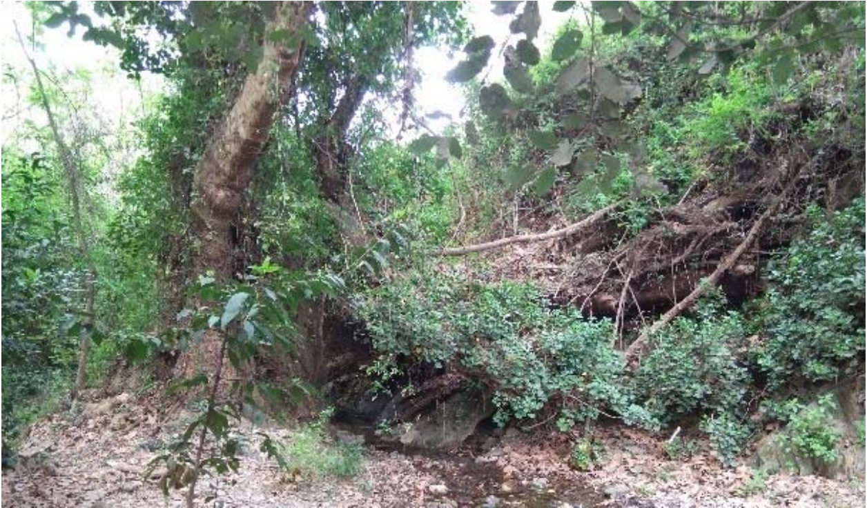
Figura 13: Vista de l'estat actual de la riera amb un talús inestable amb restes vegetals a la seva superfície
