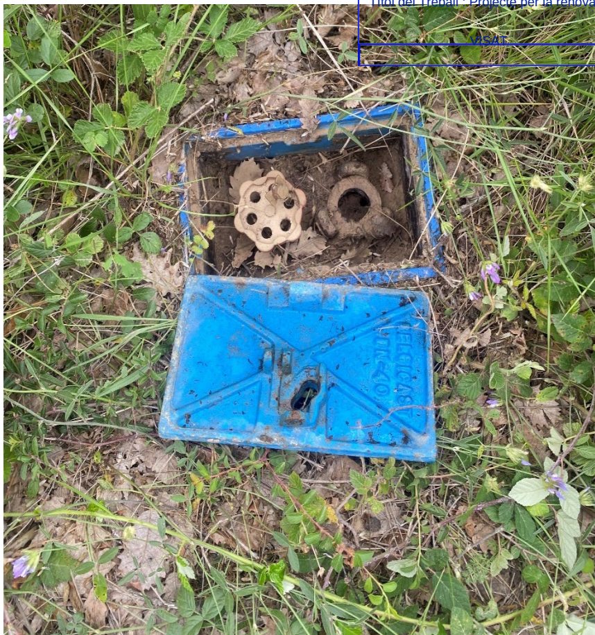
Imatge de la boca de l'hidrant
