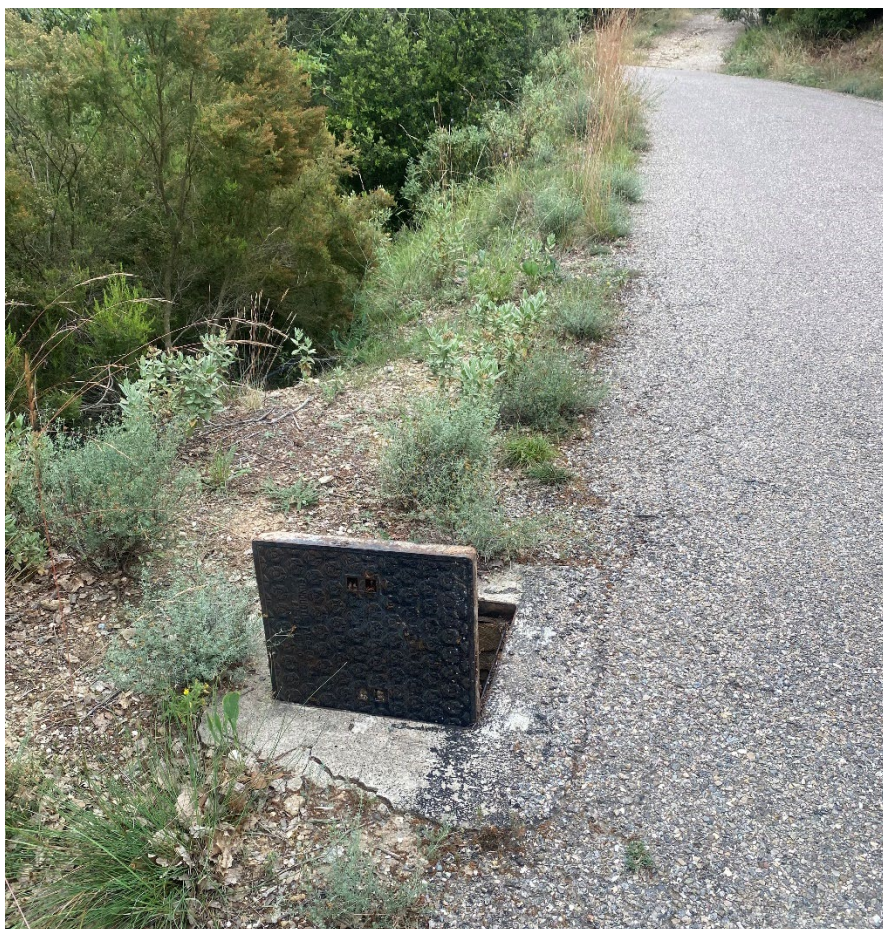
Imatge de la carretera on hi ha la ventosa ubicada
