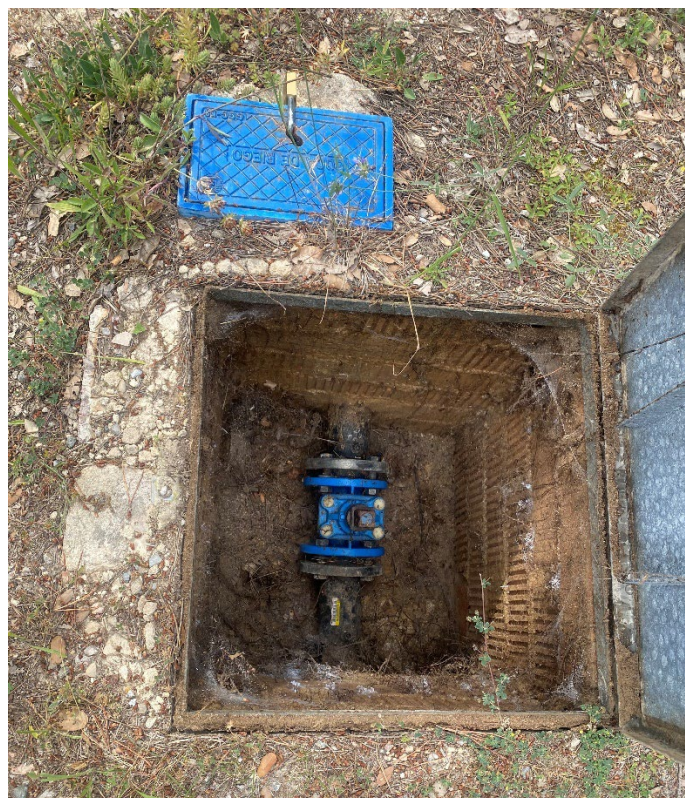
Imatge de la clau de pas al costat de la boca d'hidrant
