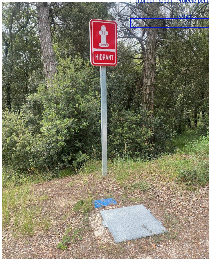
Imatge de l'hidrant i de la clau de pas
