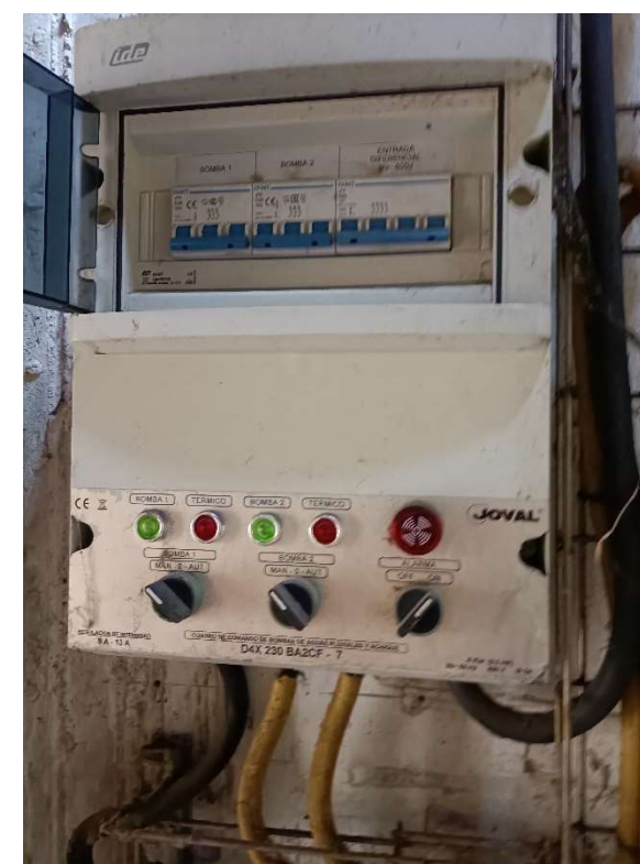
Imatge 2. Quadre elèctric existent
