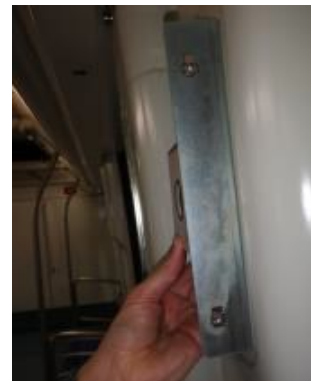
Figura 35. Instal·lació de beacon dins de panell informatiu (III).
