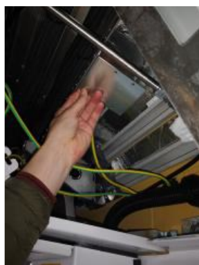
Figura 67. Instal·lació de beacon dins de capçalera (II).
