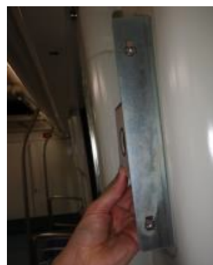
Figura 44. Instal·lació de beacon dins de panell informatiu (III).
