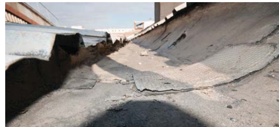
Fotografia 2 – Deteriorament de la làmina impermeabilitzant en el canaló
