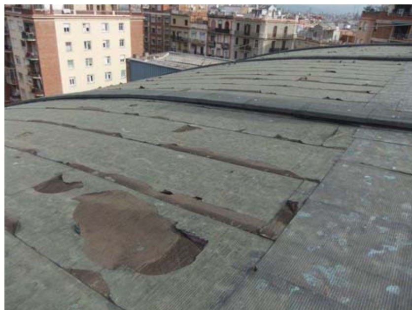
Fotografia 33 – Mal estat de la impermeabilització de coberta Zona 3
