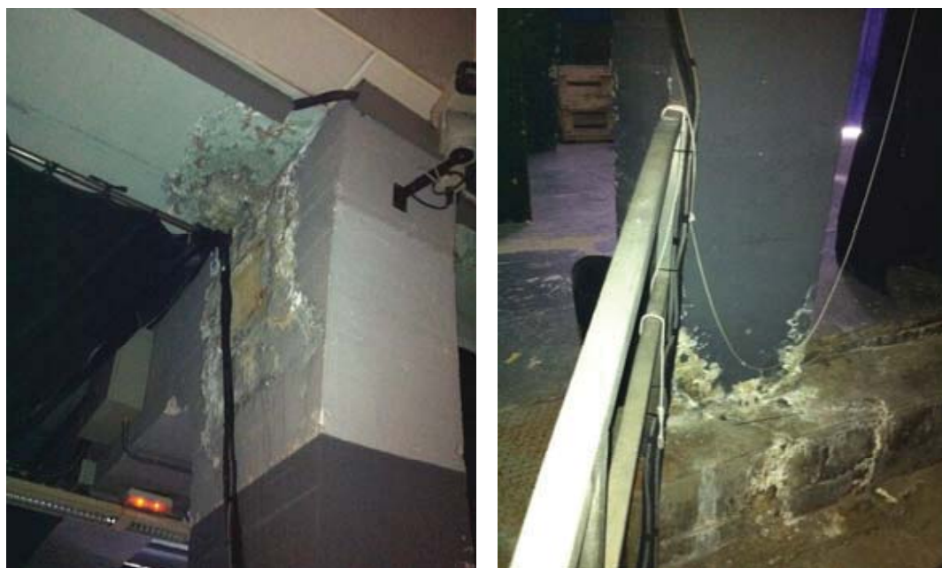
Fotografies 31 i 32 – Efflorescències en el cap i en la base del pilar de formigó
