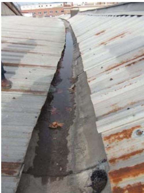
Fotografia 1- Canaló costat façana a coberta plana Zona 1
