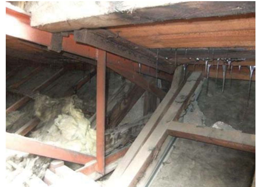
Fotografia 6 – Unió de canaló de fusta amb encavallada metàl·lica
