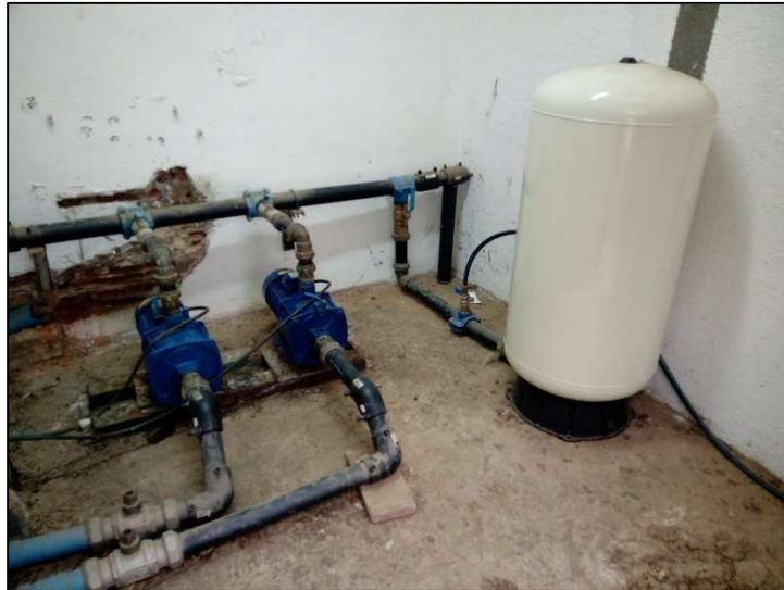
Figura 3. Equip de bombament del dipòsit de la Puntaire
