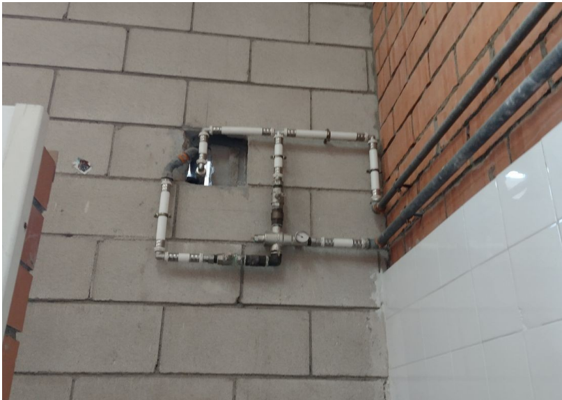
Imatge 2: Vàlvula barrejadora entrada dutxes
