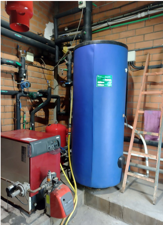
Imatge 1: Acumulador sala tècnica Pavelló de Patinatge
