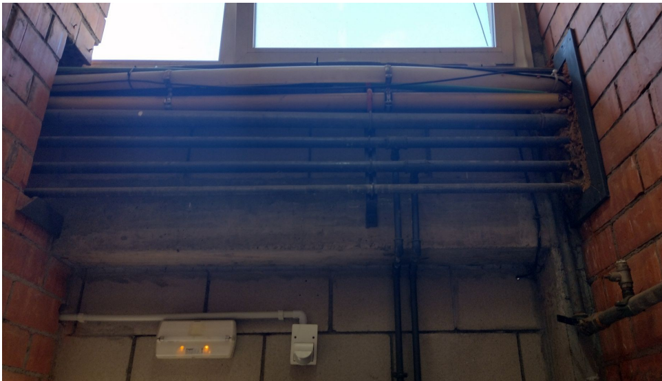
Imatge 11: canonades a substituir (tant de distribució com d'alimentació dels consums).
