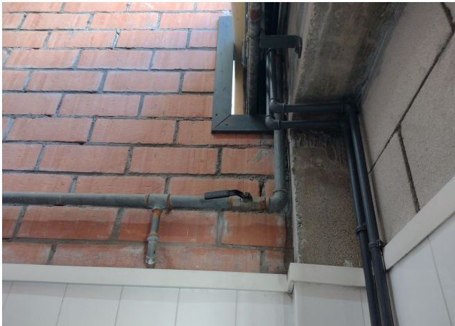
Imatge 12: exemple de canonades a substituir (tant de distribució com d'alimentació dels consums).
