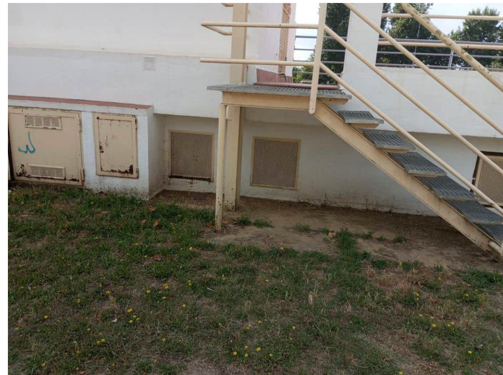
Fotografia 8. Visió de la façana posterior amb les finestres amb reixa a canviar
