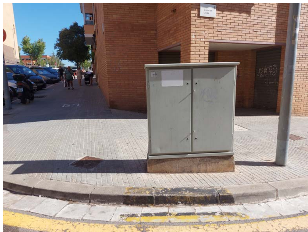
Foto 9. Quadre d'enllumenat públic al carrer Lleida nº32-34
