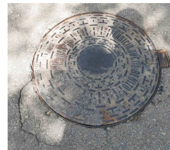
BASTIMENT I TAPA DE POU DE CLAVEGUERAM A SUBSTITUIR
