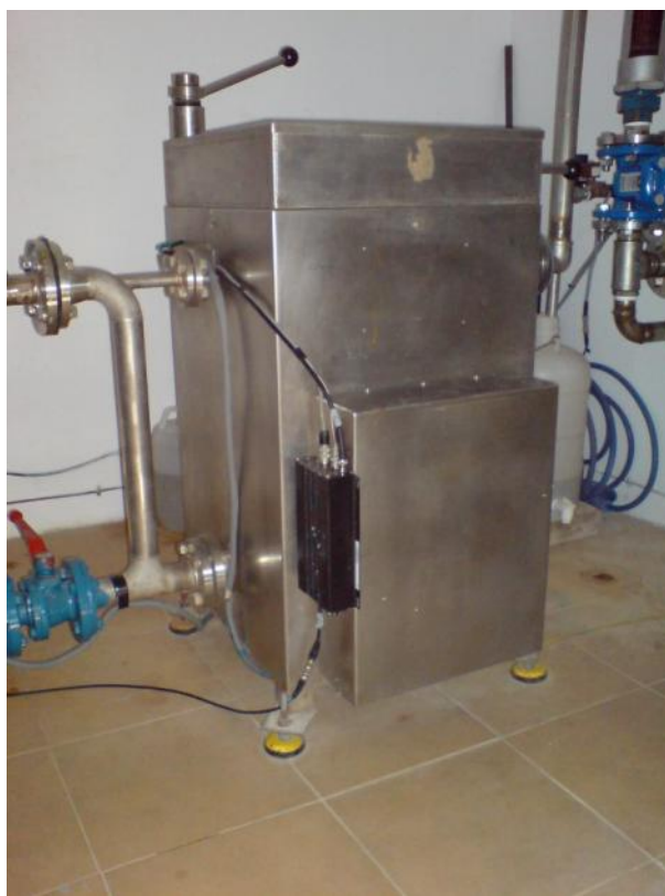
Detall del recinte d'anàlisi blindat de la xarxa XVE
