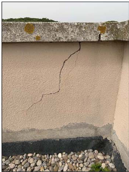
Vista general de la coberta i detalls de les fissures de l'ampit i de les peces de coronament malmeses.
