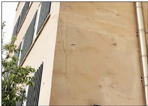
Fissures en l'arrebossat de façana.
