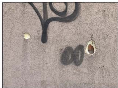
Detall de desperfece en la façana de SATE
