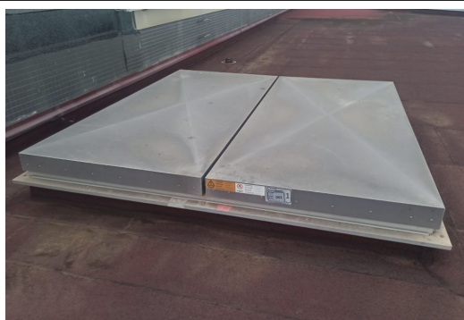
EXUTORI AIREJADOR HALL EXTERIOR
