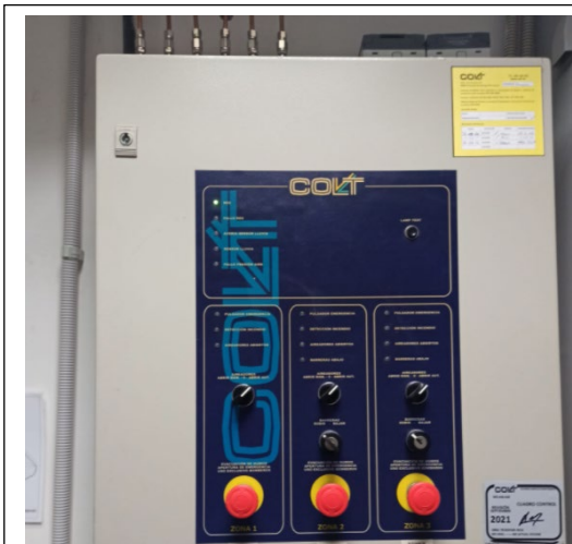
QUADRE CONTROL EXUTORIS
