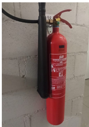
EXTINTOR DE CO2
