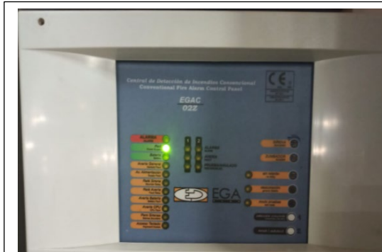
CENTRAL DETECCIO INCENDIS
