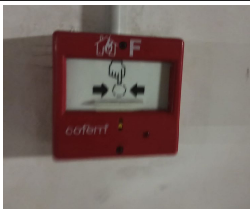
PULSADOR DE EMERGENCIA
