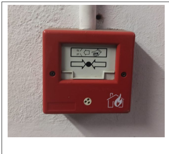
PULSADOR DE EMERGENCIA
