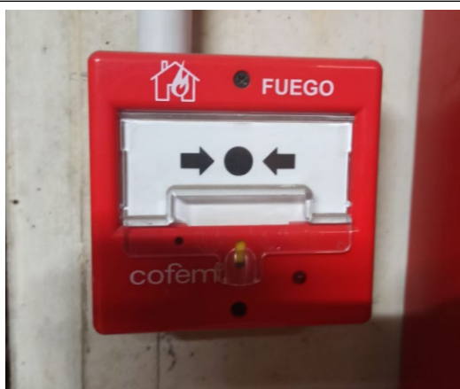
PULSADOR DE EMERGENCIA
