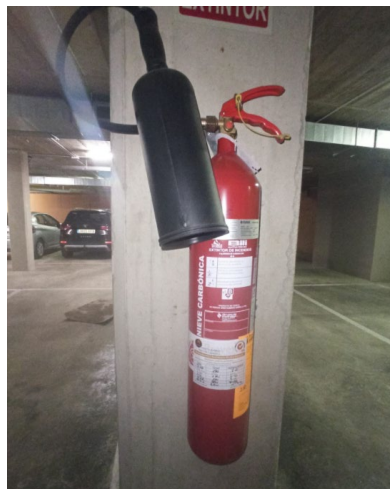
EXTINTOR DE CO2
