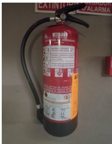
EXTINTOR DE POLS
