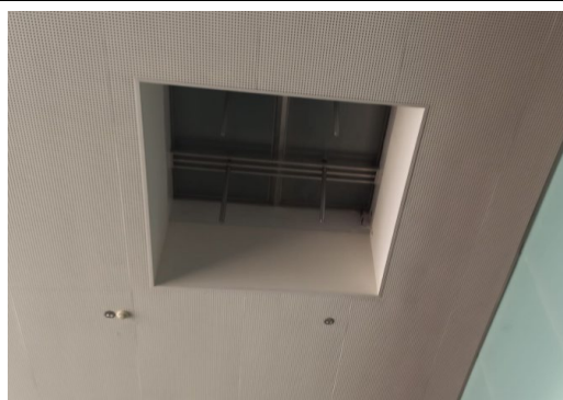
EXUTORI AIREJADOR HALL INTERIOR
