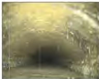
Foto: 69_1_3_10032021_094601_A.jpg Cm. Inspección Interrumpida
