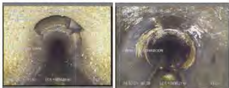
Figura 33: Escomesa mal connectada entre pous de registre 439 – 440. Falla estructural del col·lector entre pous de registre 429 – 430.
