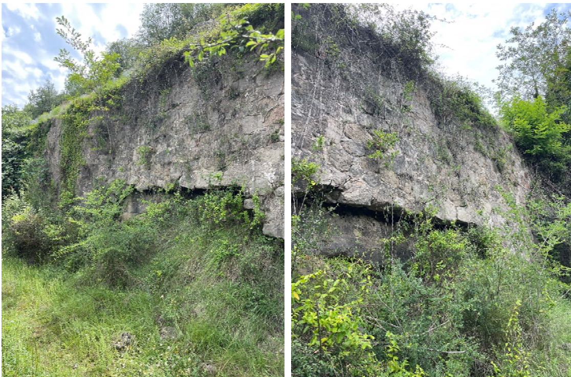
II·lustració 12. Estat general del mur de pedra amb la base soscavada i algun bloc aïllat al terra.
