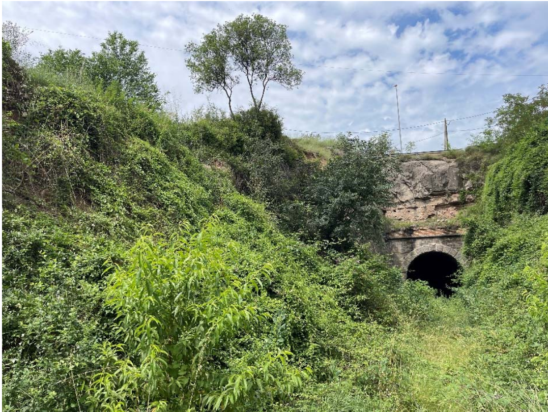
Il·lustració 14. Plans de debilitat i blocs i falques que es troben sospesos sobre el buit pocs metres per sobre de la via just a la boca del túnel.
