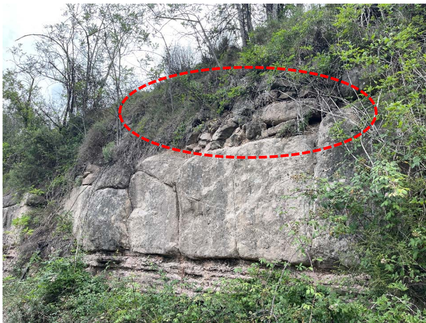
Il·lustració 16. Acumulació de petits blocs a la coronació del talús. Cal sanejament.
