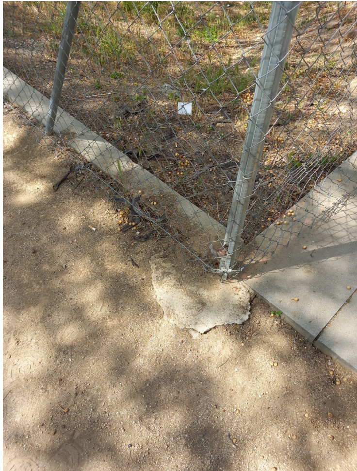
Fotografia 5. Ancoratge tanca simple torsió existent
