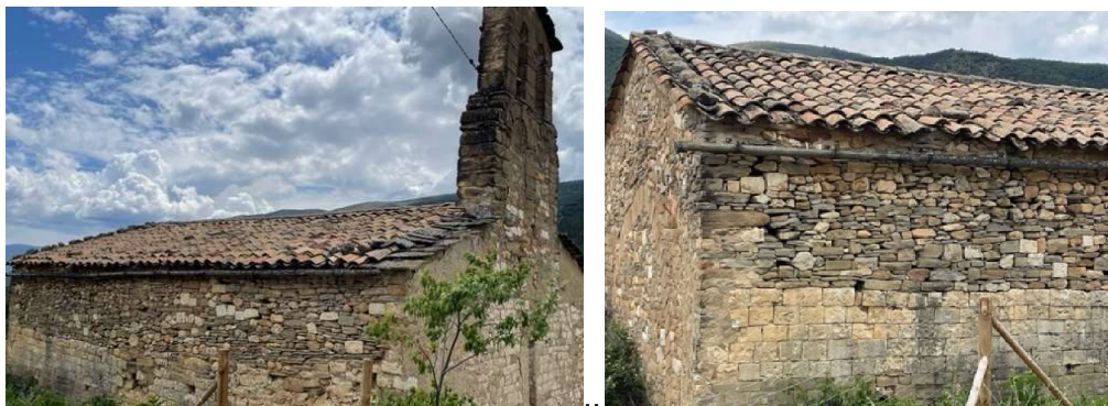
Detalls de coberta malmesa
